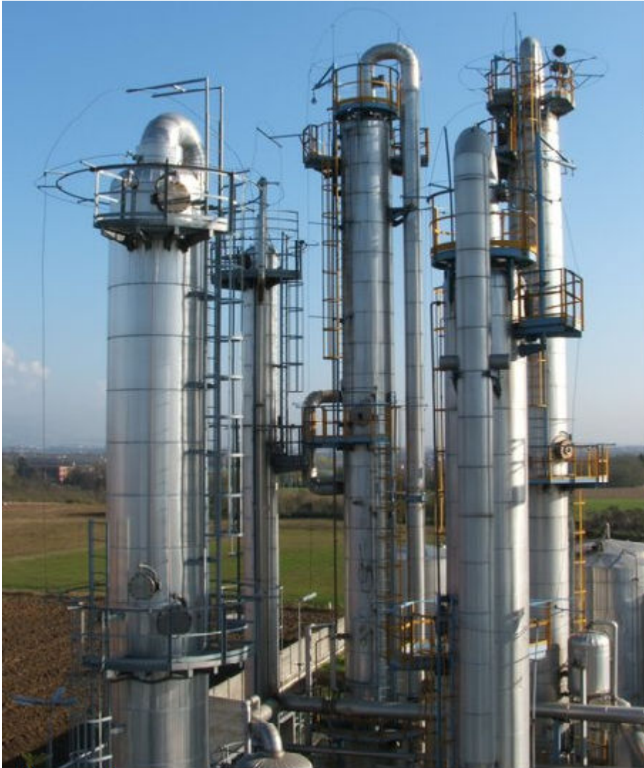
Figura 2.6: immagine impianto Topping.
