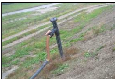
Figura 7.17: Testa di pozzo.
