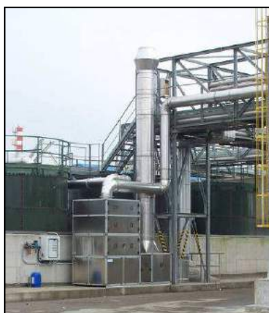
Figura 7.10: Sistema di trattamento delle emissioni.
