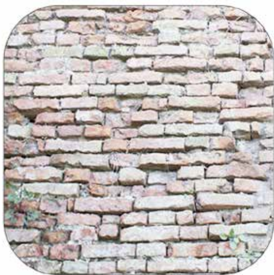
Stuccature a malte decoese in fase di distacco, con evidente ammaloramento e scarnicatura del giunto di malta.
