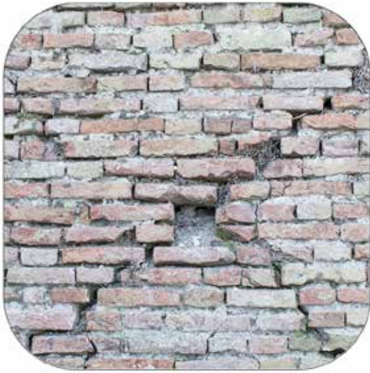
Formazione di soluzioni di continuità nel materiale dovuta a dissesti di vario genere, indice di comportamenti statici anomali.
