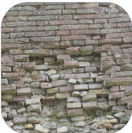
caduta e perdita di parti del paramento
