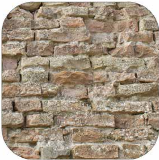
Distacco e perdita di parti del materiale causa qualità intrinseche, cicli di gelo e disgelo e escursione termica.
