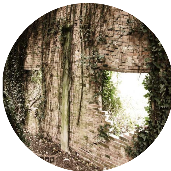
Fig.94 Porzione di edificio crollata a ridosso del bosco
