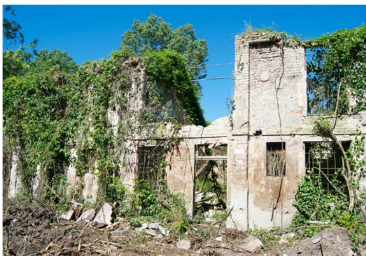
Fig. 197 Dettaglio crollo muratura
