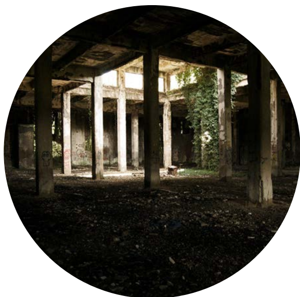
Fig.82 Reparto di filatura, particolare di una delle cinque "torri di luce"
