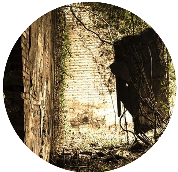
Fig.81 Porzione di solaio crollato "catturato" dai ferri della struttura
