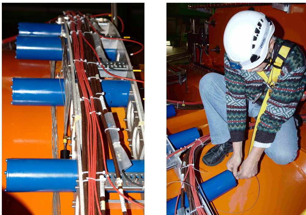
Figura 6.6: A sinistra: Fissaggio del sistema di calibrazione alla struttura A destra: Distribuzione e connessione delle fibre ottiche alle unità.
