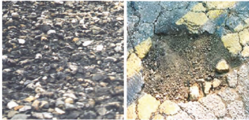
Figura 3.2: I danni provocati dall'acqua nelle pavimentazioni stradali: a) fenomeno dello stripping; b) formazione di una buca
