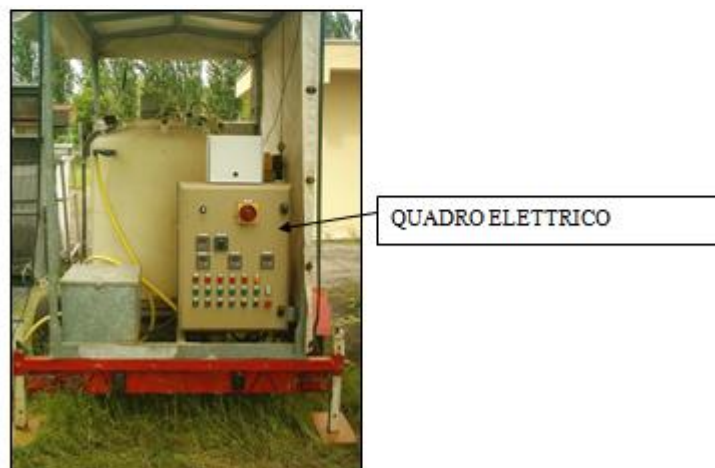
Figura 4.7 – Visione anteriore dell'impianto
