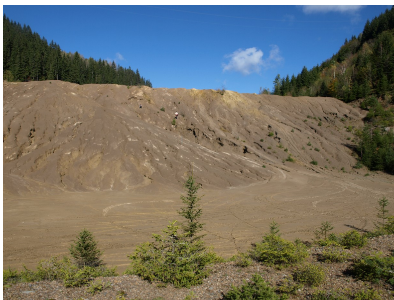
Figura 9: Immagine della diga; da notare i profondi solchi erosivi e l'assenza di vegetazione.
