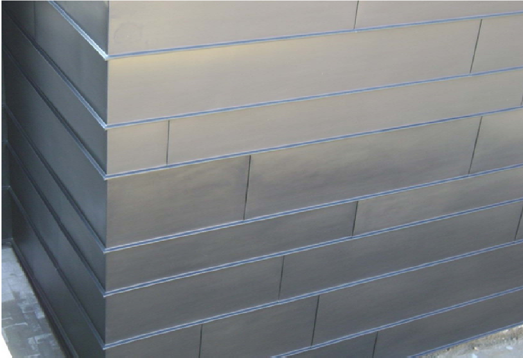
Figura 21 Rivestimento di facciata ventilata in metallo – Zinco Titanio VM ZINC a Villa d'Ogna (BG) » spigoli aggraffati (28)
