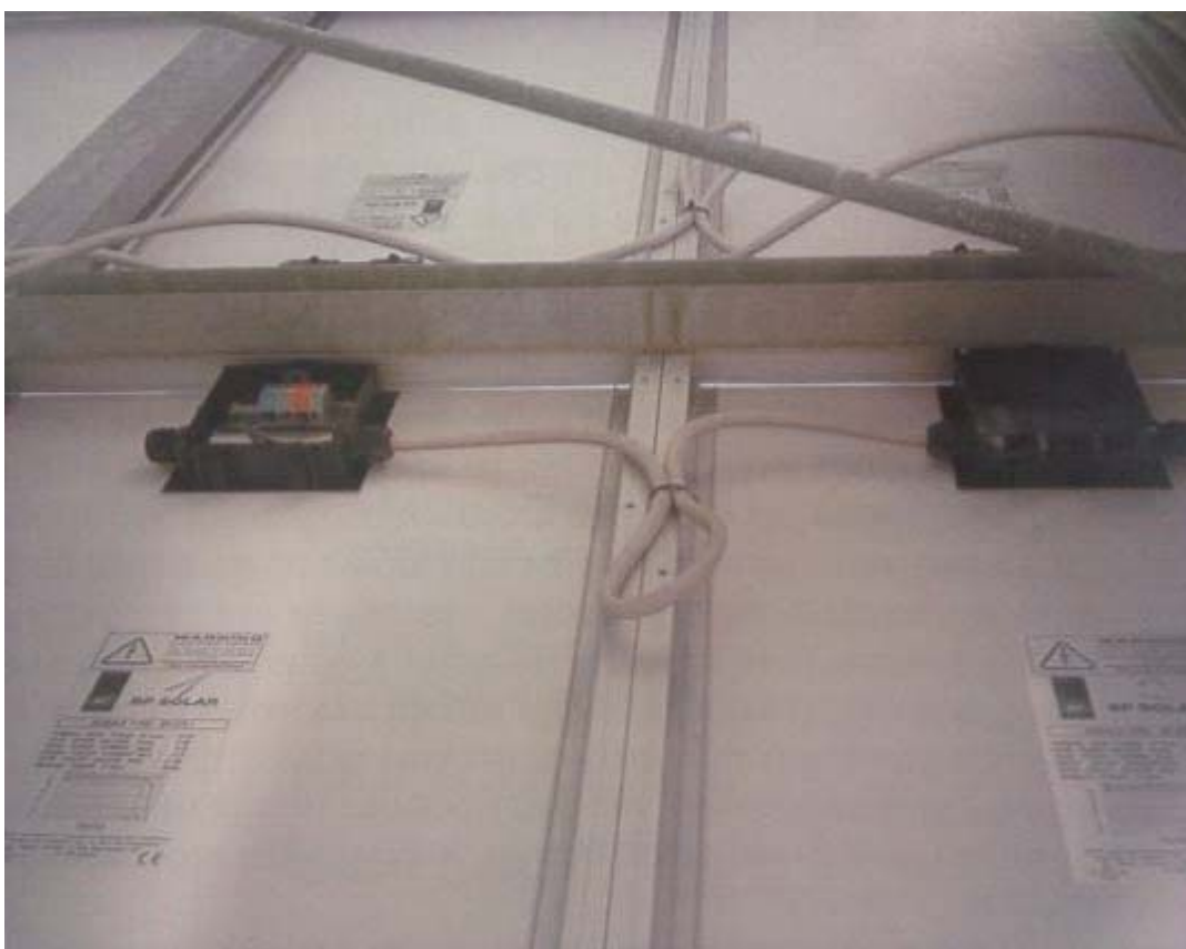
Figura 9 vista posteriore di una porzione di generatore fotovoltaico costituito da moduli monocristallini. (9)
