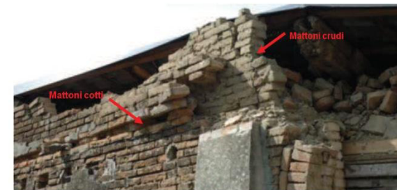
Figura 1. Il crollo ha messo in evidenza il paramento esterno in mattoni cotti (di colore tendente al rosso-arancione) e i mattoni crudi disposti sul paramento interno (di colore tendente al grigio-giallo).
