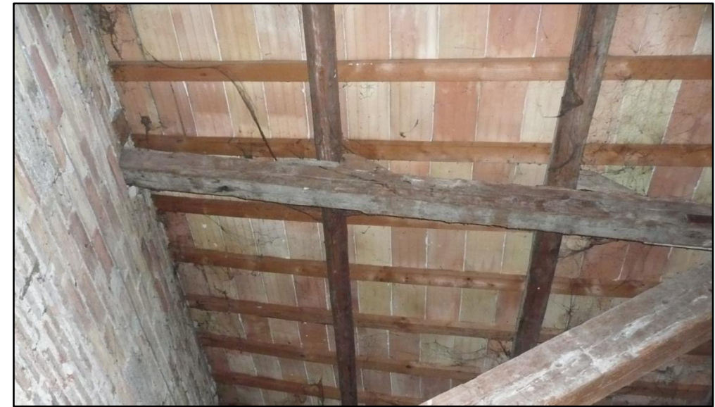
Intradosso di un solaio in legno a tripla orditura con rivestimento in laterizio in un edificio del centro storico di Pergola
