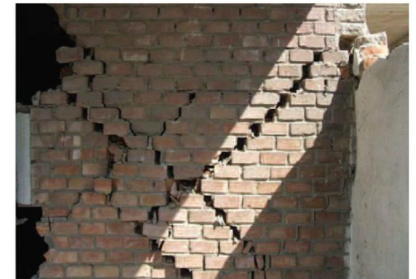
Figura 3. Crisi di un pannello murario di soli diatonici appartenente ad un edificio di tre piani. Si notino le lesioni di scorrimento passanti per i giunti di malta e la debolezza che, in questo caso, è costituita dall'interfaccia malta-laterizio dotata di poca aderenza.
