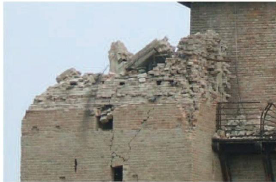
Figura 4. Muratura multistrato in mattoni come emerge dal crollo di una torre monumentale. San Felice sul Panaro (MO).
