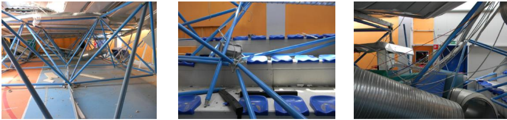
Figure 56 - collapsed truss system in Portomaggiore (FE)
