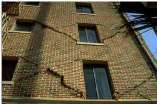
Figura 59: Meccanismo di danno per flessione con formazione di fessure orizzontali
