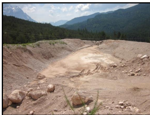
Fig. 19: bacino di ritenzione dei sedimenti.
