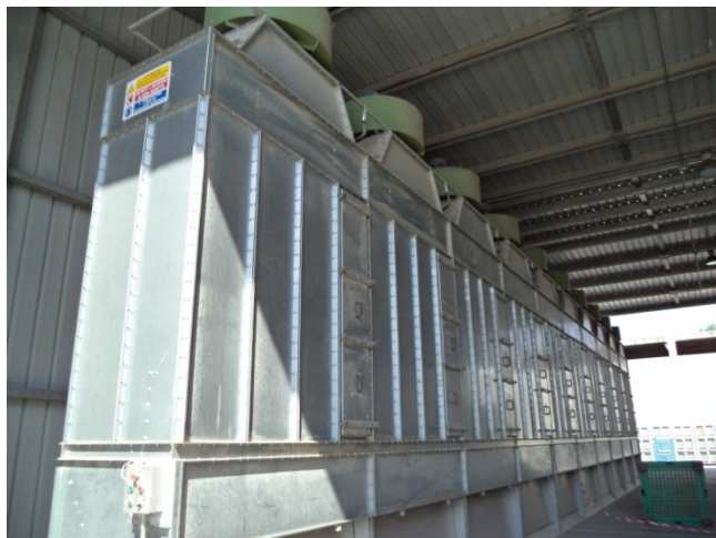
Figura 18: Filtri a manica per l'aspirazione delle polveri durante lo scarico in buca
