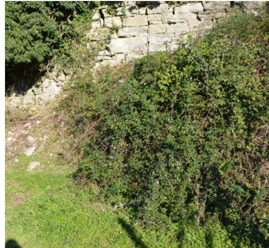
Fig. IV.26 Rovo comune su paramenti murari
