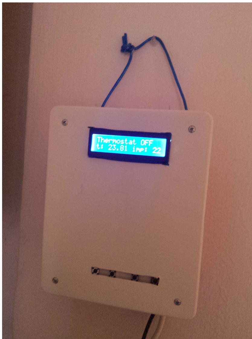
Figura 3.18: Dettaglio della visualizzazione delle informazioni nel display del termostato
