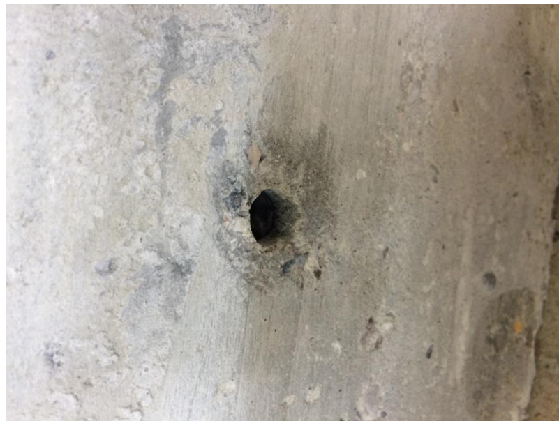
Figura 90. Dettaglio scorrimento barra-calcestruzzo “at the end” prova P4C1BCN10 – 18/09/14
