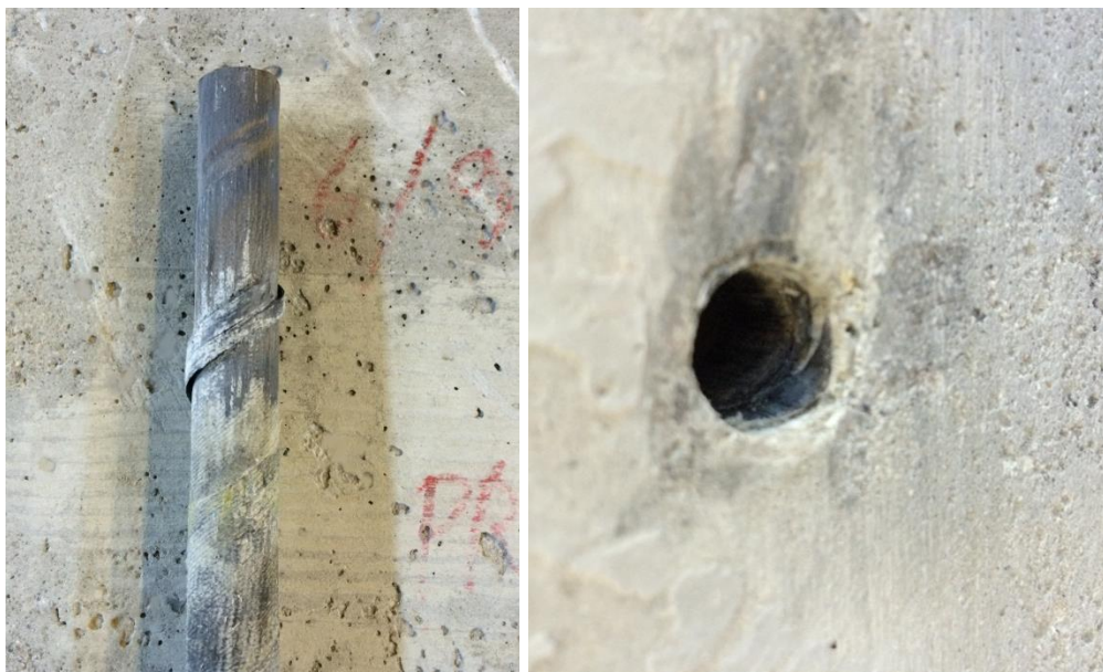
Figura 105. Dettaglio della barra estratta: distacco del filamento di fibra di carbonio che avvolgeva la barra e parti di questa attaccati al calcestruzzo - prova P8C1BCN12 – 22/09/14
