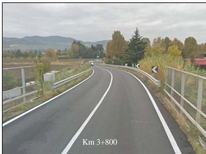
Figura 3.10: Mancanza di transizione tra i sistemi di ritenuta
