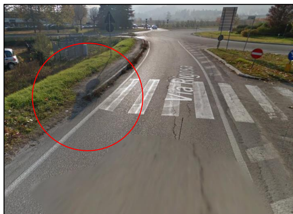
Figura A.26: Tratto V – Rampa marciapiede inadeguata
