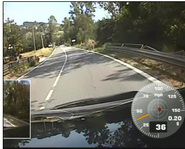
Figura A.66: Tratto XV – Barriera danneggiata
