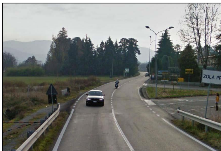
Figura A.21: Tratto IV - Elementi pericolosi nell'isola triangolare
