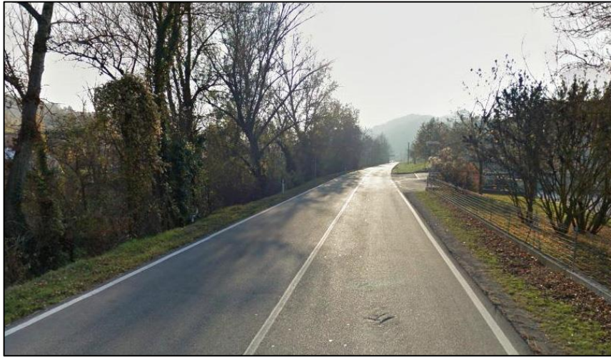
Figura A.53: Tratto XIII - Margine stradale non protetto
