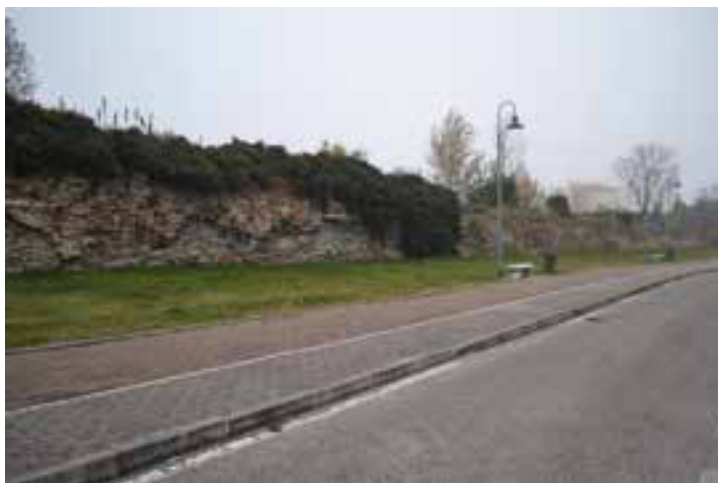
Fig. 4. Le mura lungo il parcheggio accessibile da circonvallazione Piazza d'Armi. Dietro a questa parte di mura è presente un giardino di quartiere.
