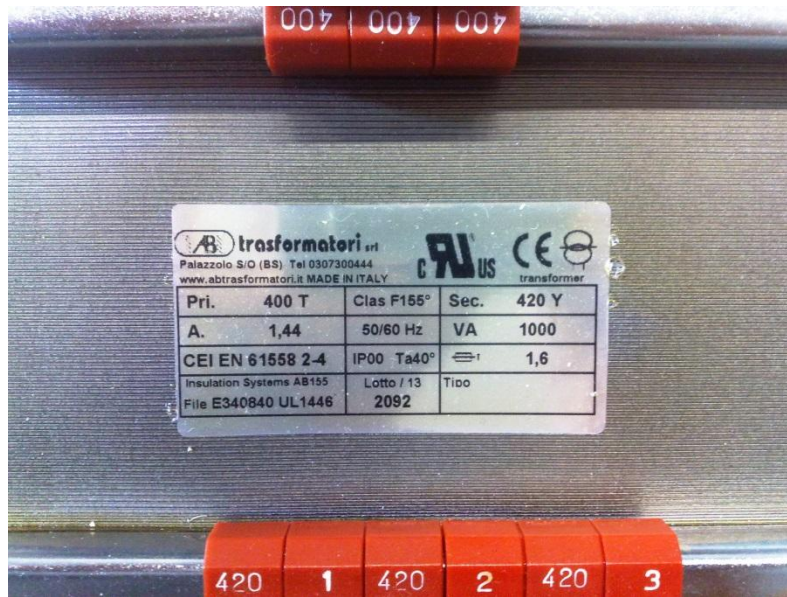
Figura 3.7 – dati di targa dei trasformatori
