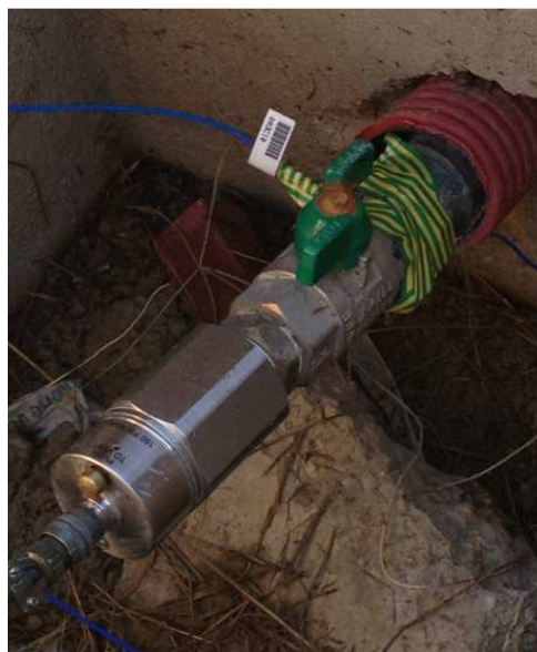
Figura 4.3- Idrofono montato nella parte terminale della condotta.
