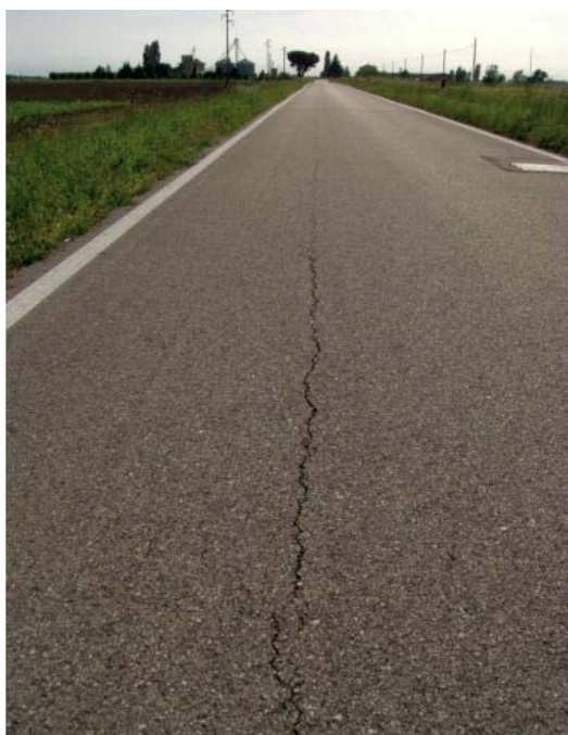
Figura 2-51 Fessura longitudinale in corrispondenza della zona di carico
