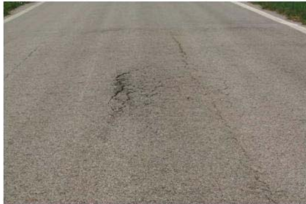
Figura 2-45 Fessurazione diffusa a "pelle di cocodrillo"
