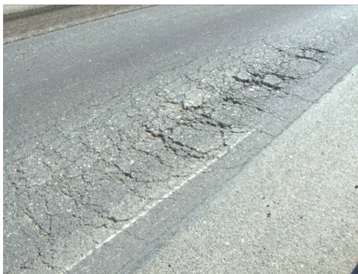
Figura 6-2 Particolare frattura a pelle di coccodrillo della pavimentazione eseguita nel 2008
