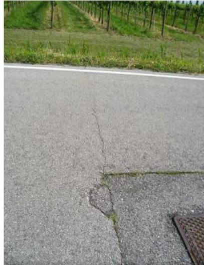
Figura 2-13 Lesioni trasversali provocate probabilmente dall'inserimento successivo del pozzetto di ispezione
