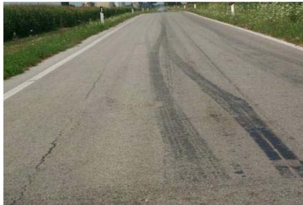
Figura 2-44 Testimonianza delle lesioni longitudinali presenti nella pavimentazione con evidenti cedimenti differenziali
