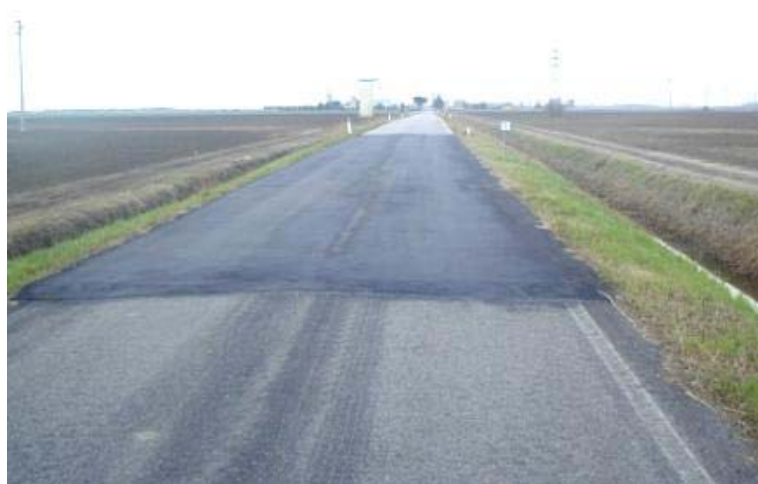
Figura 2-47 Rifacimento di un tratto del manto stradale a causa dell'elevata entità del dissesto
