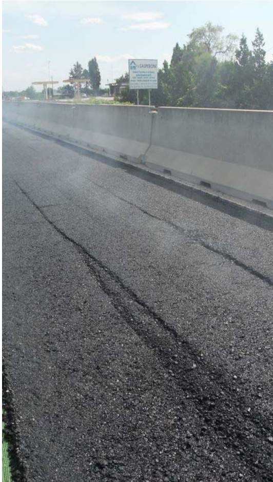
Figura 4-45 Fessurazioni dovute al ritiro della geogriglia
