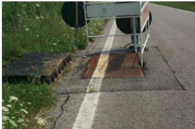
Figura 2-10 Fenomeno di subsidenza in corrispondenza di un pozzetto d'ispezione
