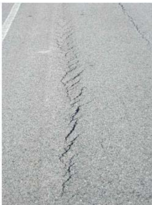
Figura 2-39 Grave lesione nel centro di una corsia, in prossimità delle zone sottoposte a carico
