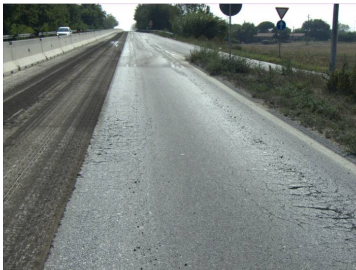
Figura 6-1 Lesioni in prossimità del km 224+500 della SS 67 carreggiata nord
