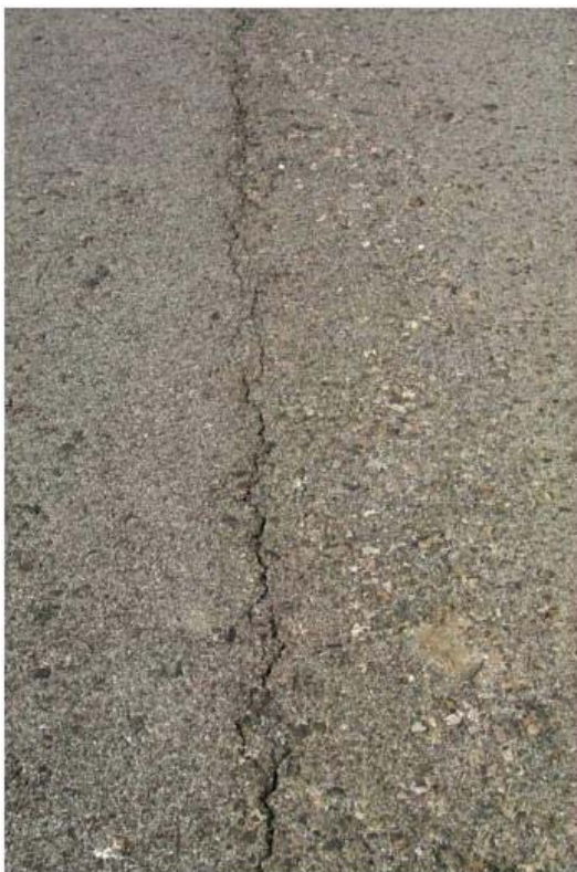
Figura 2-37 Particolare della lesione sull'asse stradale (apertura 1,0/1,5 cm) con evidenti diramazioni laterali
