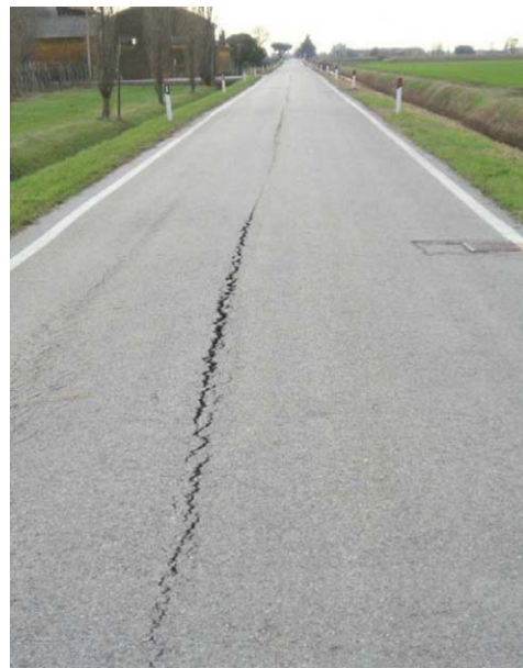
Figura 2-35 Frattura longitudinale a centro strada
