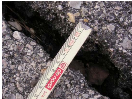
Figura 2-41 Misurazione frattura longitudinale (4-5 cm)
