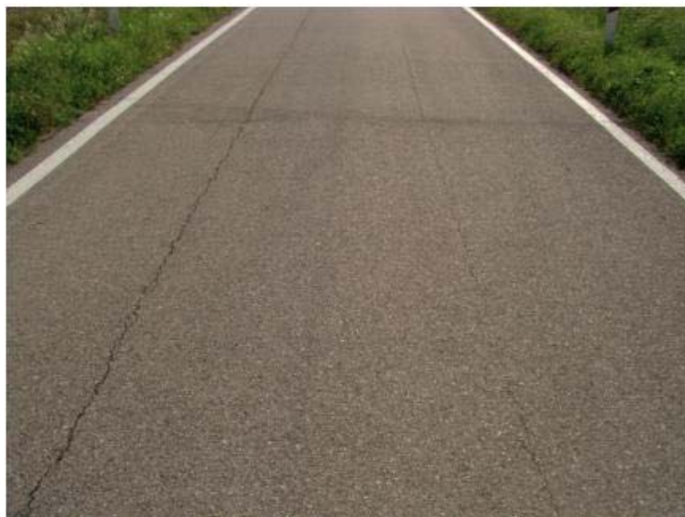
Figura 2-48 Lesioni longitudinali in prossimità della zona di carico presente nella pavimentazione con evidenti cedimenti strutturali
