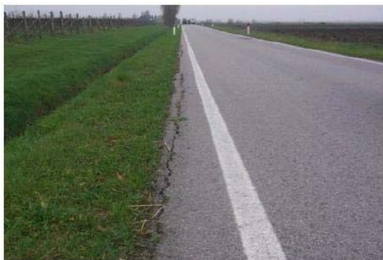
Figura 2-7 Lesioni longitudinali al bordo strada
