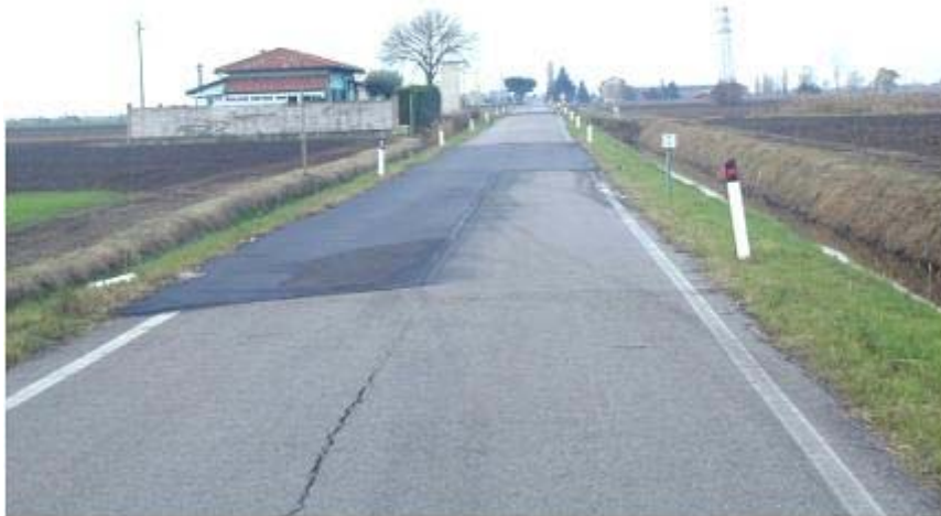
Figura 2-38 Tratto in cui è stato necessario eseguire un nuovo intervento di manutenzione consistente nella scarifica e aggiunta di uno strato di asfalto
