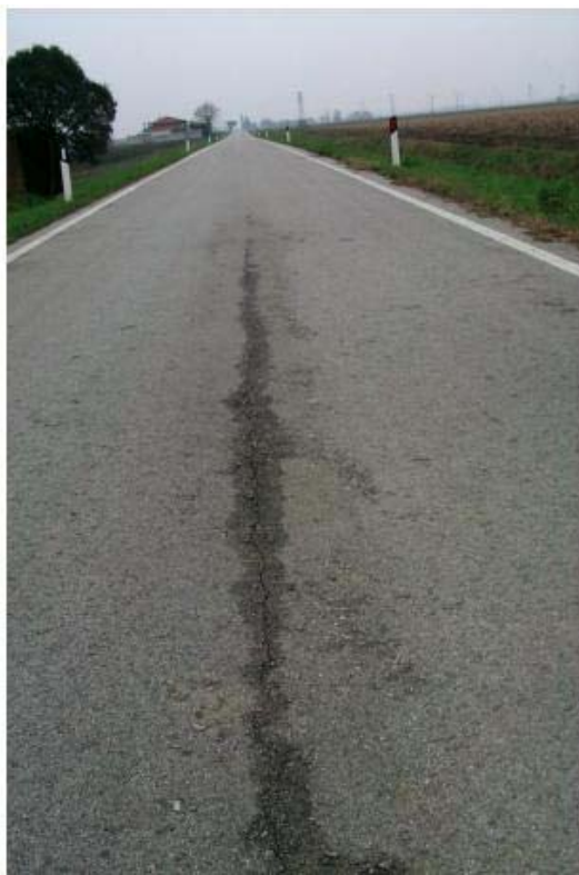
Figura 2-36 Lesione longitudinale con risalita d'acqua
