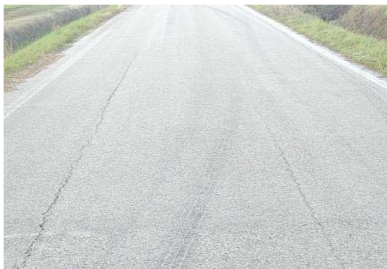
Figura 2-46 Fessurazione con conseguenti ormaie a causa della scarsa portanza del terreno sottostante non assorbita dal rinforzo in geogriglia
