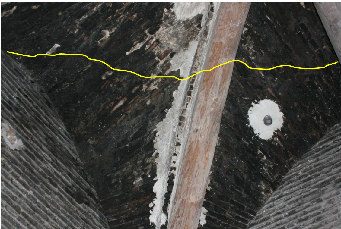
2. 28 Lesioni riscontrate in corrispondenza della volta a crociera del vano di accesso
