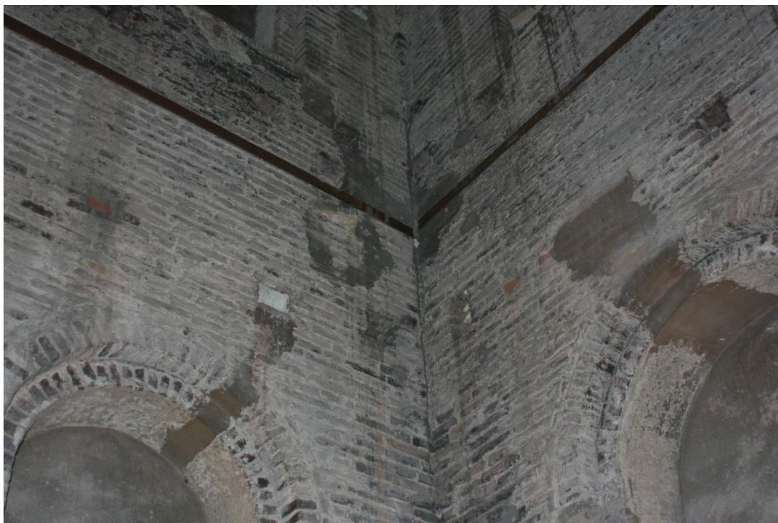
2. 36 Lesioni in corrispondenza delle aperture del terzo vano
