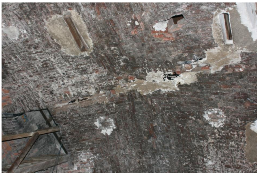
2. 40 Lesione della volta a crociera sottostante la cella campanaria che la attraversa per tutta la sua larghezza
