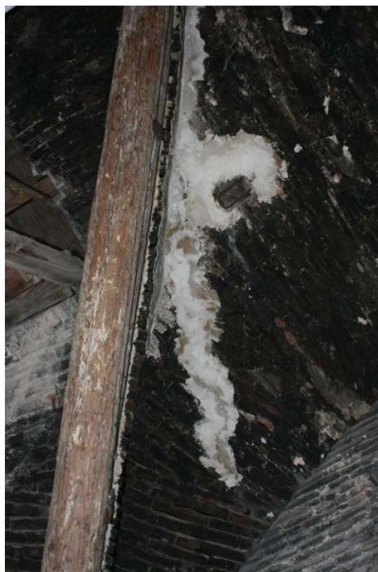
2. 29 Lesioni riscontrate in corrispondenza della volta a crociera del vano di accesso
