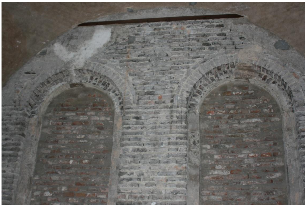
2. 33 Lesioni in corrispondenza delle finestre del secondo vano in vicinanza delle aperture
