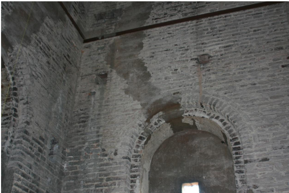
2. 35 Lesioni in corrispondenza delle aperture del terzo vano
