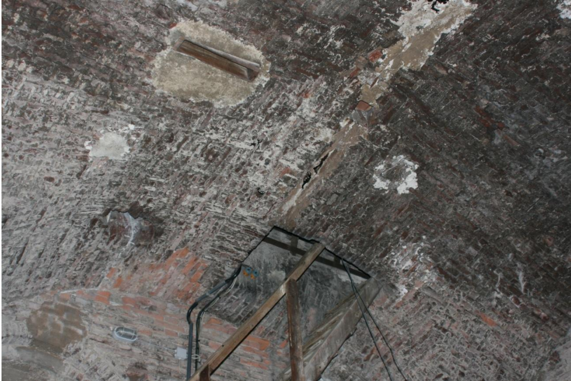
2. 38 Lesione sulla volta a crociera sottostante la cella campanaria
