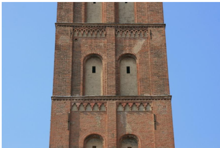
2. 41 Lesioni in corrispondenza dei paramenti esterni
