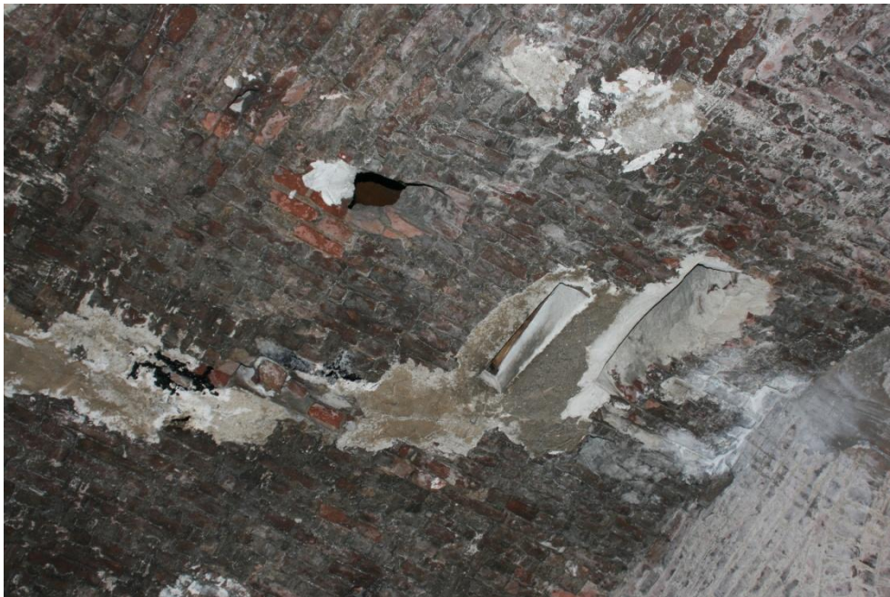
2. 39 Lesione sottostante la volta a crociera sottostante la cella campanaria
