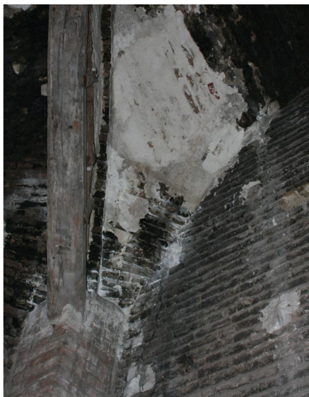
2. 26 Quadri fessurativi riscontrati sulla volta a crociera del vano di accesso
