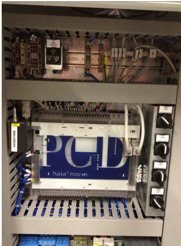
Figura 5.2: Dettaglio dell'Energy Manager implementato su PLC Saia Burgess PCD2.M5540.
