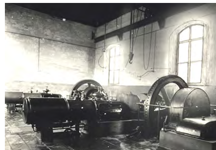
Fig.7: Pompa centrifuga a vapore
