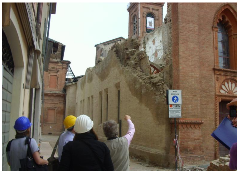
Figura 8-1 Sopralluogo al Duomo di Mirandola. Giugno 2013
