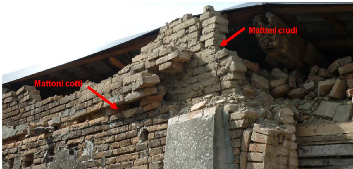
Figura 5-8 Il crollo ha messo in evidenza il paramento esterno in mattoni cotti (di colore tendente al rosso-arancione) e i mattoni crudi disposti sul paramento interno (di colore tendente al grigio-giallo).
