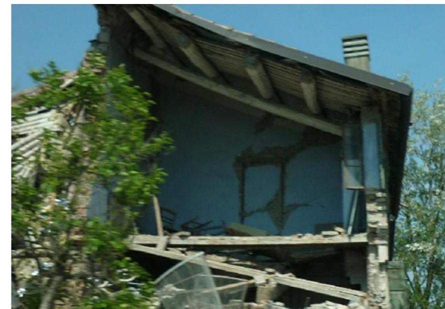
Figura 5-7 Copertura spingente; solaio e copertura non collegati alla parete.
