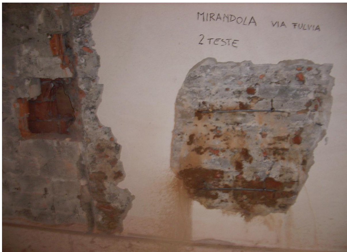
Figura 5-5 Fotografia scattata durante un rilievo in un edificio di tre piani fuori terra. E' evidenziato il numero di teste rinvenuto sotto l'intonaco.
