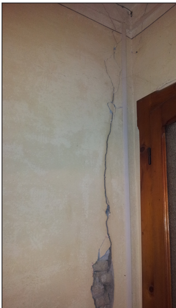
Figura 10.2.2.1.2.: Edificio II, particolare lesione.
