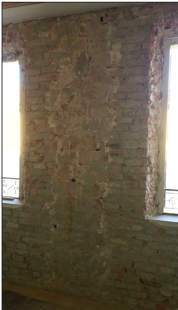
Figura 7.4.2.3.3.: Edificio III, piano secondo, canna fumaria (fonte studio BBP ingegneria).
