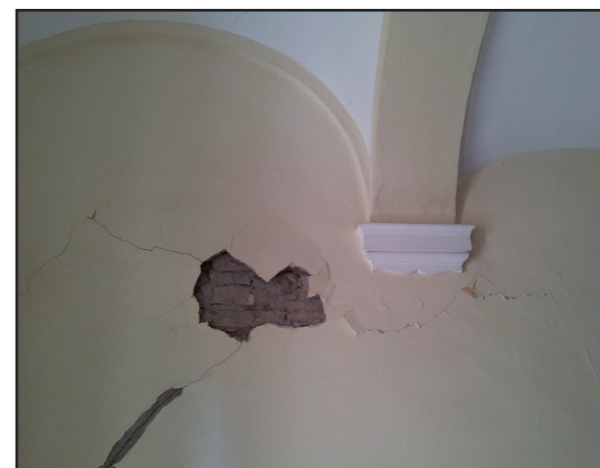
Figura 10.1.2.1.5.: Edificio I, scale, particolare delle lesioni a taglio.
