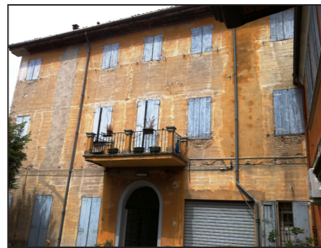
A-B. In alto a sinistra si possono vedere le lesioni orizzontali che segnalano l'attivazione del cinematicismo. La foto sotto mostra lo stesso prospetto senza intonaci e si possono vedere tutte le disconnessioni presenti nella muratura.
