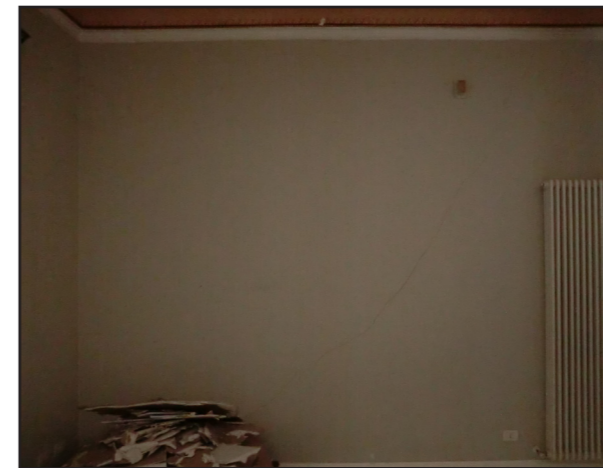
Figura 10.1.2.2.1.: Edificio I, appartamento 1, particolare della lesione a taglio.
