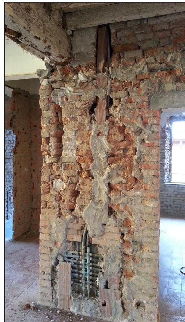
Figura 7.4.2.3.5.: Edificio III, piano secondo, muratura (fonte studio BBP ingegneria).
