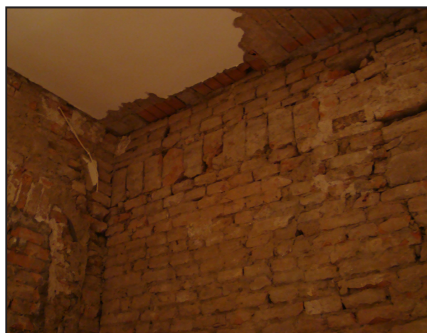
Figura 10.3.2.1.2.: Edificio III, particolare lesioni dovute alla mancanza di ammorsamenti e a taglio (fonte studio BBP ingegneria).
