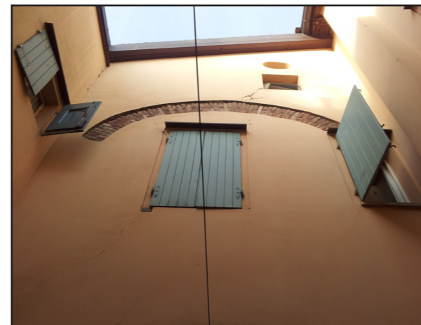
Figura 10.1.2.1.3.: Edificio I, scale, particolare delle lesioni a taglio e per assenza di ammorsamento.
