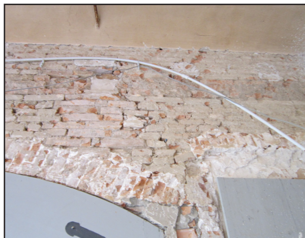
Figura 10.4.1.2.: Edificio IV, particolare della parte antica lesionata a taglio.
