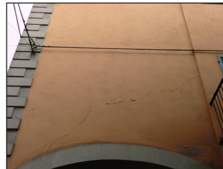
A. Lesione a taglio posta al di sopra dell'arco del portico su via Bai.
