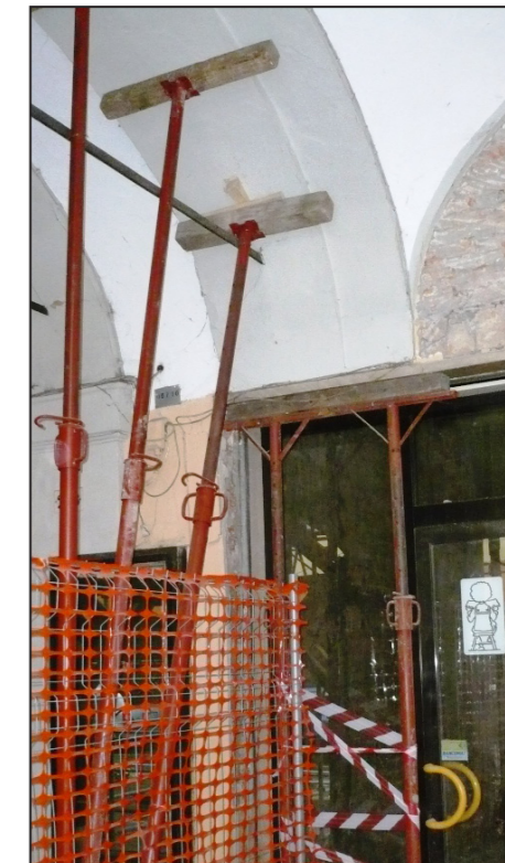
F. Lesioni a taglio dei paramenti murari causati da nicchie ricavate all'interno degli stessi e fessurazioni dovute ad un arco del portico la cui imposta è un architrave di una vetrina di un esercizio commerciale al piano terra.
