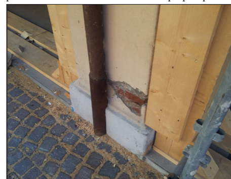
D. Lesione orizzontale alla base del pilastro del portico dell'edificio II che segnala il cinematiso di primo modo che interessa la facciata conseguente ad un probabile slittamento della stessa nel proprio piano.
