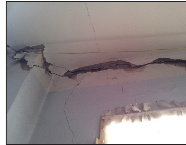
Figura 10.1.2.2.7.: Edificio I, appartamento 4, particolare ribaltamento.
