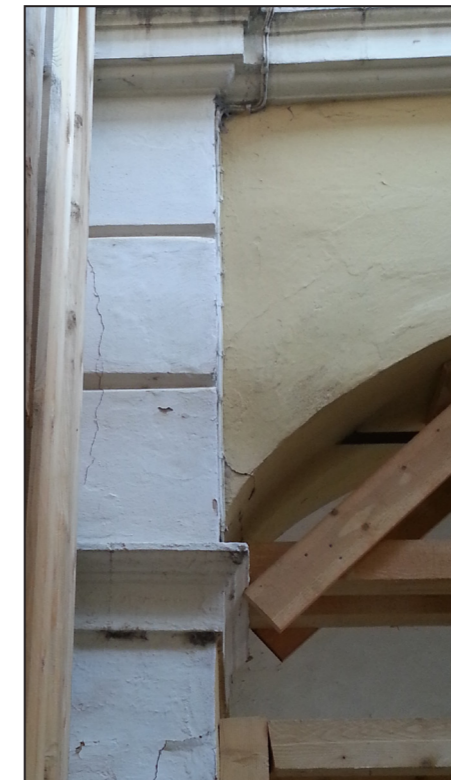
F. Altre lesioni del portico.
