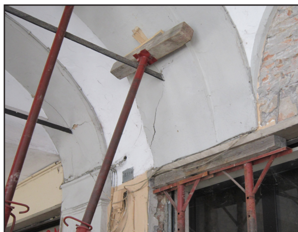
Figura 10.1.1.1.: Edificio I, portico, particolare della lesione all'imposta dell'arco.
