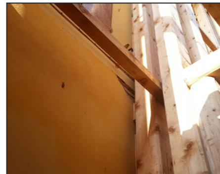
D. Lesione a taglio che parte dalla finestra del primo piano per poi attraversare tutto il paramento.
