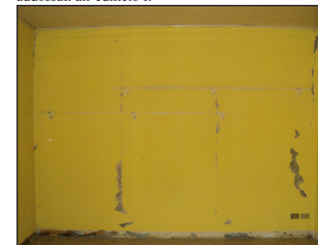
H. Interno dell'edificio IV e particolare delle lesioni verticali di distacco dei paramenti portanti solamente addossati all'edificio I.
