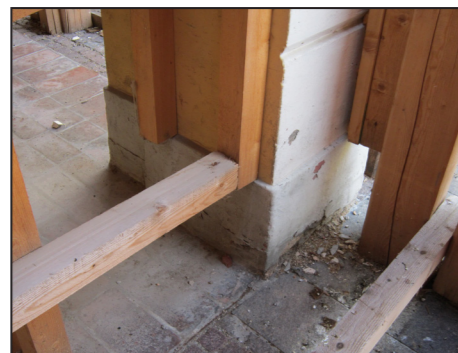
A. Il cinematiso della facciata è evidenziato dalle lesioni orizzontali alla base delle colonne del portico. Nella foto il pilastro nell'angolo nord-est dell'edificio III.
