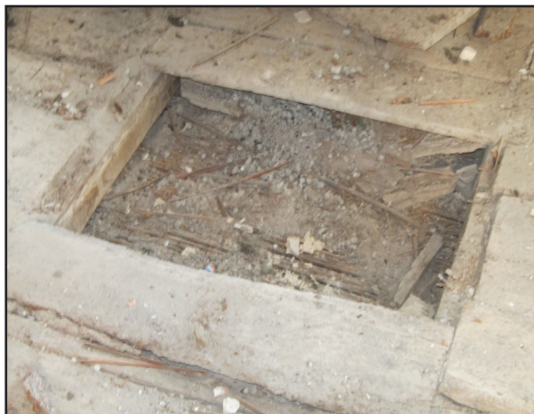
Figura 7.2.2.3.2.: Edificio I, appartamento 4, particolare del tavolato molto degradato.
