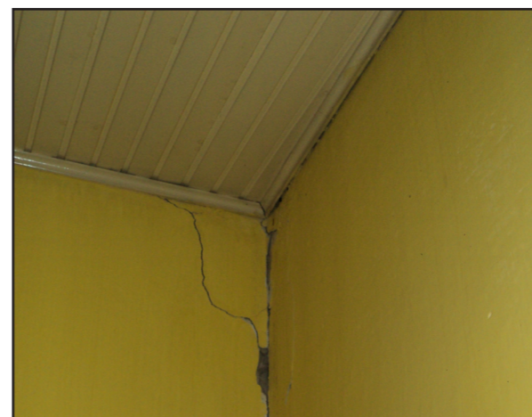
Figura 10.4.2.1.2.: Edificio IV, particolare del distacco dall'edificio I.
