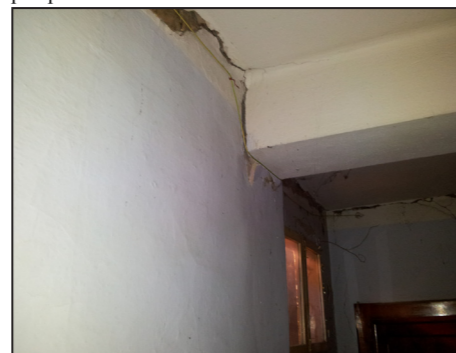
D. La foto mostra l'interno dell'appartamento al secondo piano che affaccia sul cortile interno. Si notino le lesioni che testimoniano il distacco della parete portante esterna che innesca un ribaltamento fuoridalla piano. Le fessure sono passanti e sono indicate in prospetto.
