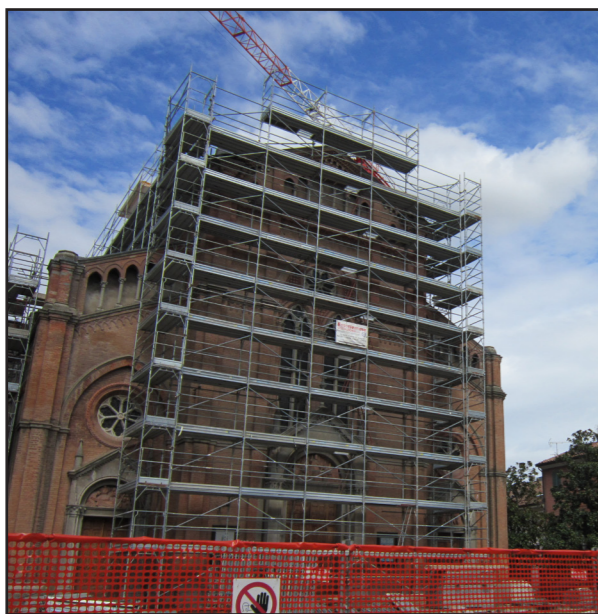
Figura 4.1.6.8.: Foto della nuova chiesa San Silvestro, in stile Neogotico, lesionata dai recenti eventi sismici e sottoposta a restauro.
