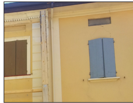
C. Sopra e sotto la finestra di destra appartenente all'edificio II si notano le lesioni che anche qui hanno coinvolto le fasce di piano del fabbricato.
