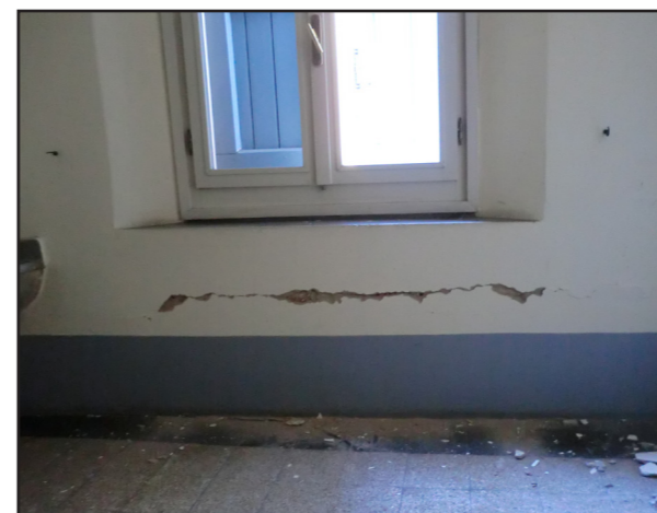
Figura 10.1.2.1.4.: Edificio I, scale, particolare del primo pianerottolo con lesione orizzontale al di sotto del bancale della finestra (cerniera cilindrica).
