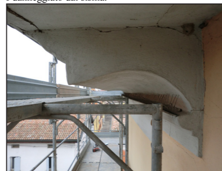
B. Particolare del cornicione in arellato dell'edificio I danneggiato dal sisma.
