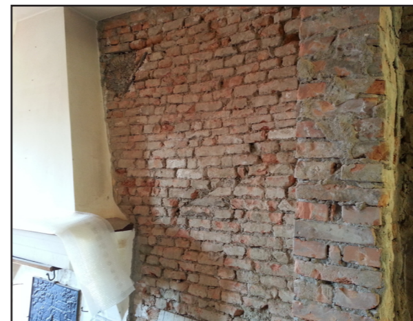
Figura 10.3.2.2.1.: Edificio III, particolare lesioni dovute alla mancanza di ammorsamenti e a taglio (fonte studio BBP ingegneria).
