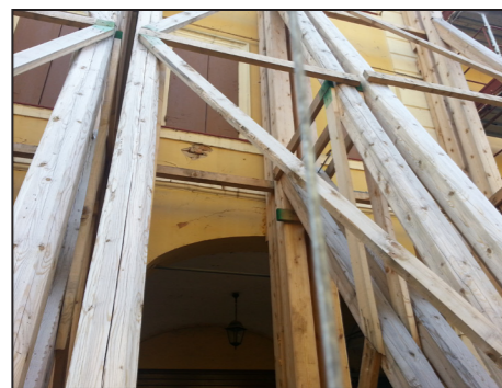
B. Facciata puntellata dell'edificio III a causa del ribaltamento della facciata su via Matteotti. Si vedono le tipiche lesioni a taglio che hanno interessato le fasce di piano del fabbricato.
