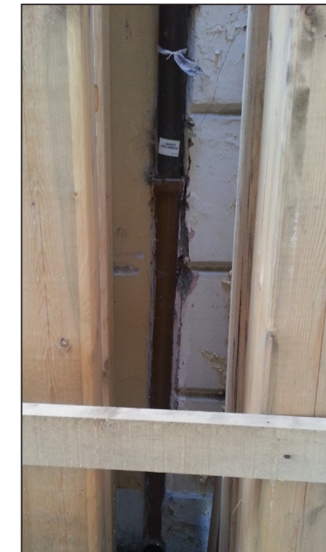
G. Lesione a causa dell'assenza di ammassamento tra la parete portante su via Pigozzi e quella della facciata su via Matteotti. Un altro segnale del cinetismo innescatosi.
