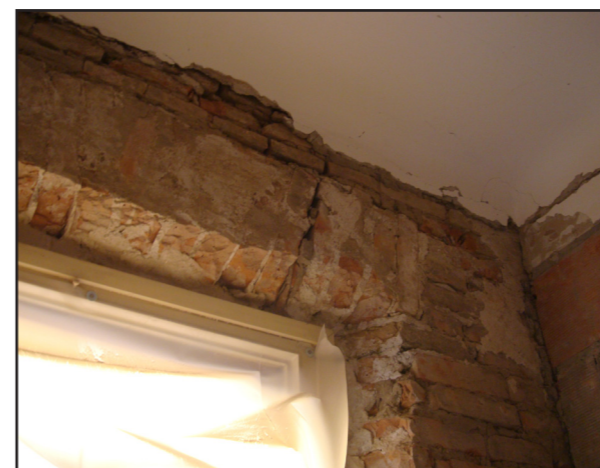
Figura 10.3.2.2.2.: Edificio III, particolare lesioni a taglio dei paramenti esterni (fonte studio BBP ingegneria).
