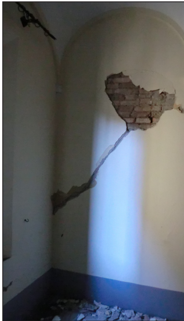
Figura 10.1.2.1.6.: Edificio I, scale, particolare della lesione a taglio.
