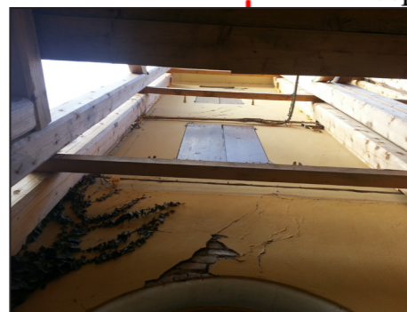
A. Fasce di piano lesionate a taglio
