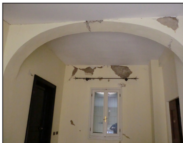
Figura 10.1.2.1.7.: Edificio I, scale, particolare delle lesioni a taglio e dell'arco.
