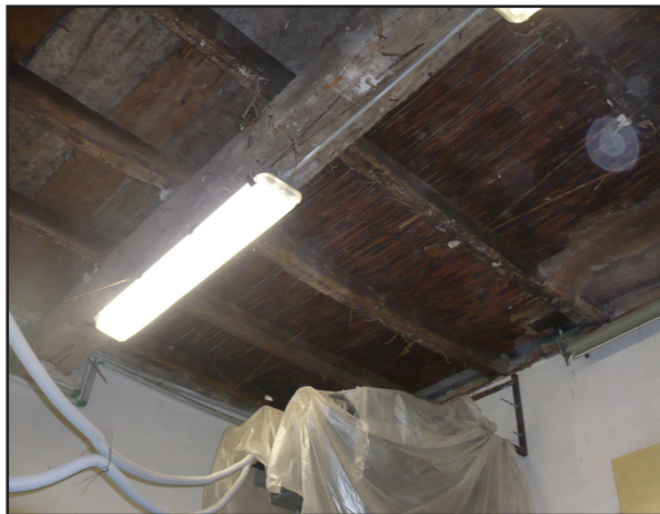
Figura 7.2.2.1.4.: Edificio I, negozio 1, particolare dei solai.
