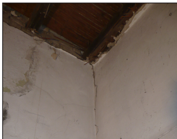
Figura 10.1.2.1.1.: Edificio I, libreria, particolare delle lesioni.
