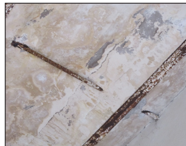
Figura 7.5.2.1.4.: Edificio IV, autorimessa e portico nell'ala sud, particolare della catena.
