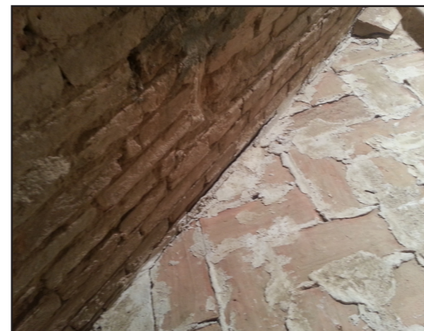
Figura 10.3.2.2.3.: Edificio III, attivazione cinematismo (fonte studio BBP ingegneria).
