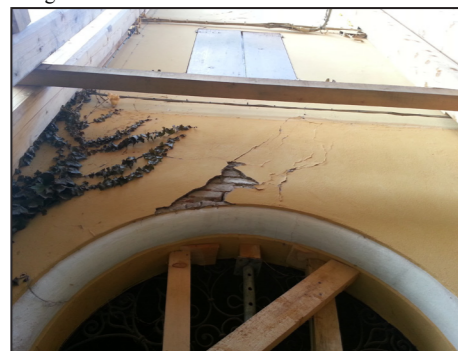
B. Particolare della lesione al di sopra del portone d'ingresso dell'edificio III.
