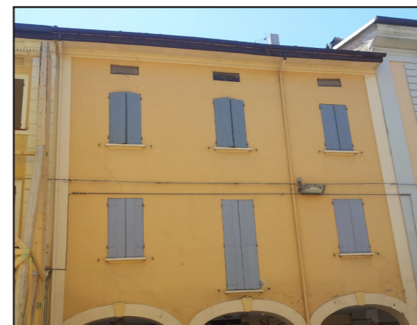
Figura 10.2.1.1.: Edificio II, quadro fessurativo facciata.
