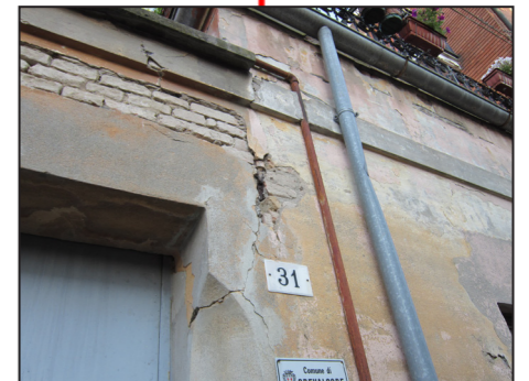
E. Lesione per mancato ammorramento della recinzione con l'edificio IV. Principio di attivazione del meccanismo ipotizzato.
