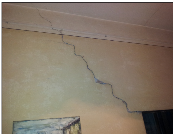
Figura 10.2.2.1.1.: Edificio II, particolare lesione.
