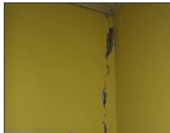
Figura 10.4.2.1.1.: Edificio IV, particolare del distacco dall'edificio I.
