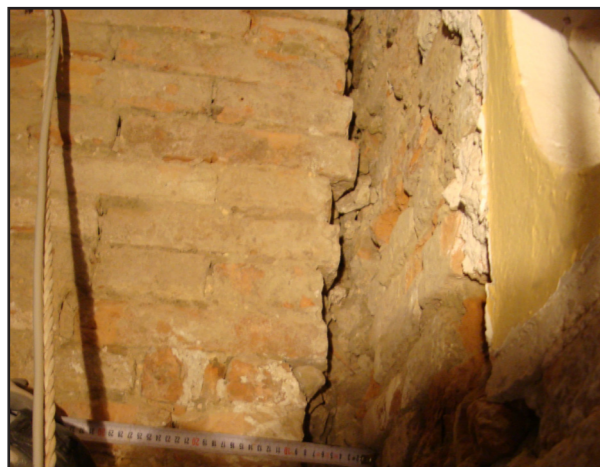
Figura 10.3.2.1.1.: Edificio III, particolare lesioni dovute alla mancanza di ammorsamenti (fonte studio BBP ingegneria).
