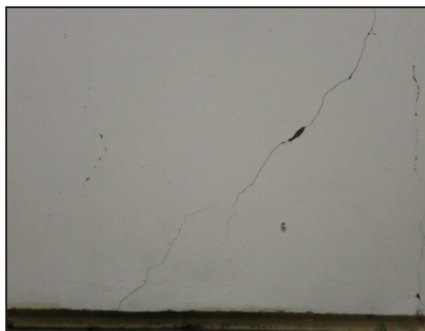
Figura 10.1.2.1.2.: Edificio I, libreria, particolare delle lesioni a taglio.
