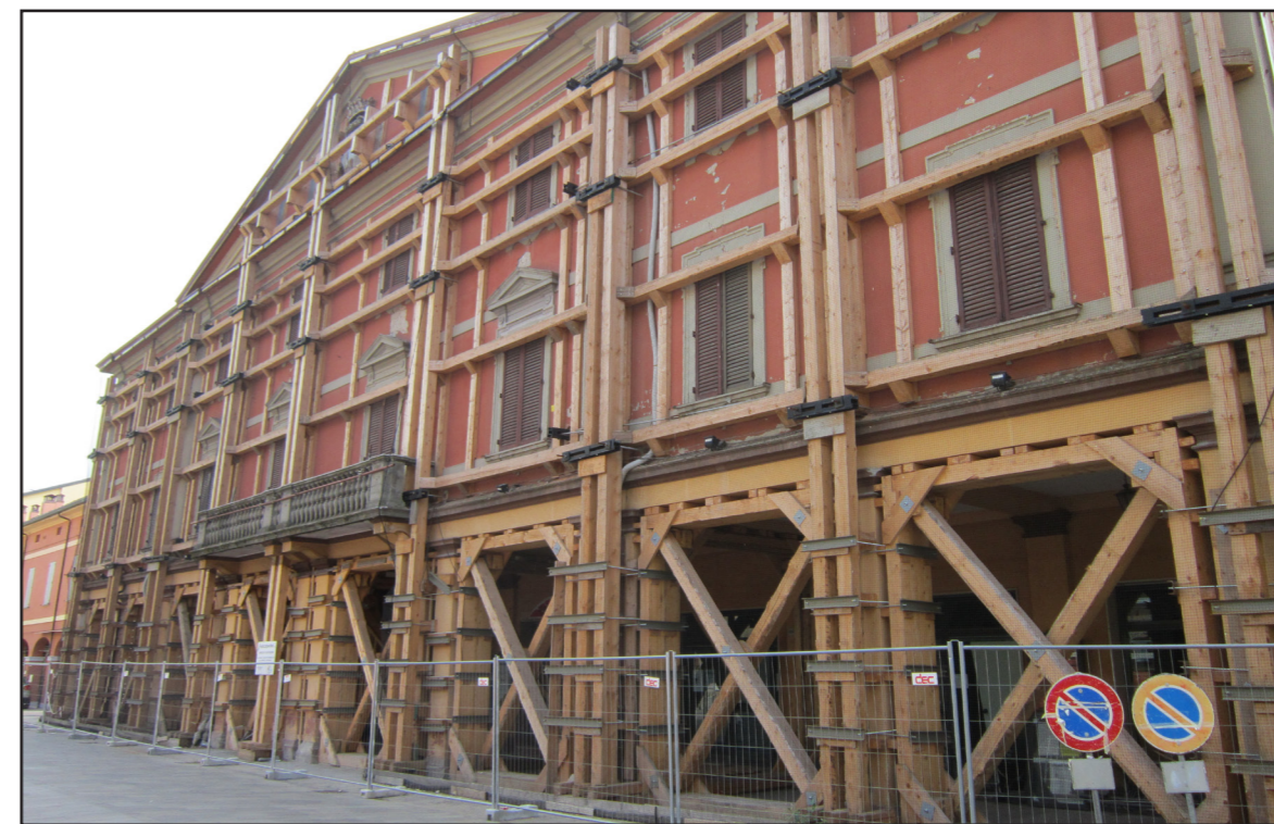
Figura 4.1.6.15.: Palazzo Comunale danneggiato dal sisma.
