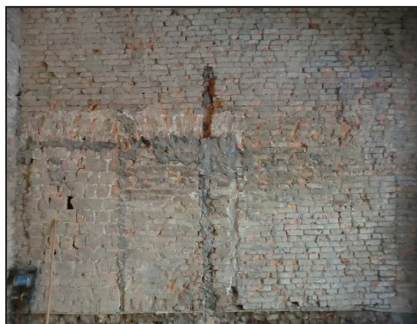
Figura 7.2.2.1.11.: Edificio I, negozio 1, particolare delle aperture tamponate.
