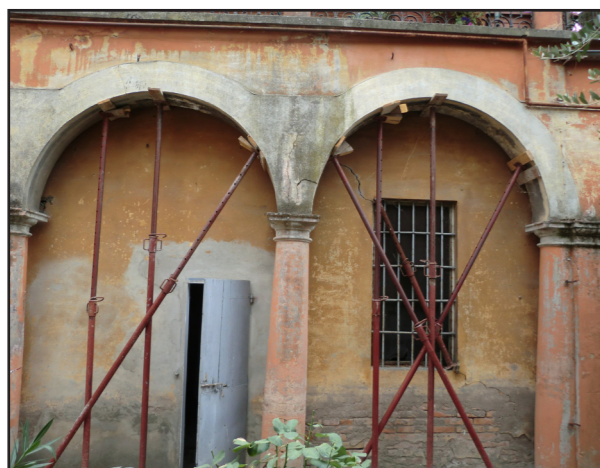
Figura 10.4.1.1.: Edificio IV, particolare della parte antica lesionata.
