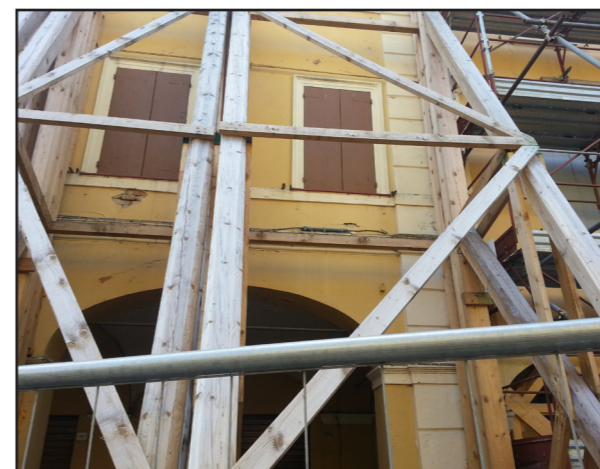
Figura 10.3.1.1.: Edificio III, particolare lesioni in facciata (fonte studio BBP ingegneria).
