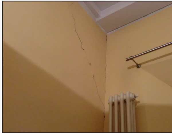
Figura 10.1.2.2.3.: Edificio I, appartamento 2, particolare ribaltamento composto.
