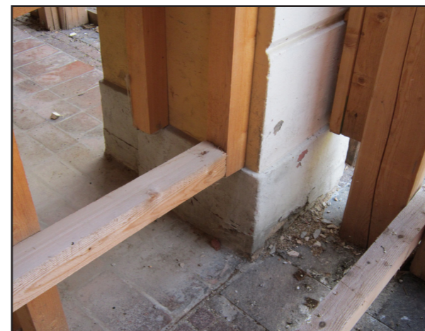
Figura 10.3.1.2.: Edificio III, particolare lesioni alla base delle colonne del portico.
