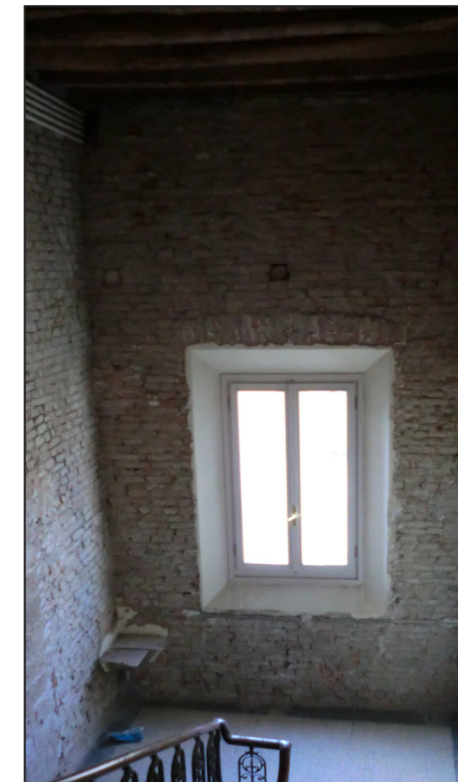
D. Finestra dell'ultimo pianerottolo dello scalone interno. A sinistra si possono vedere delle lesioni dei maschi murari.
