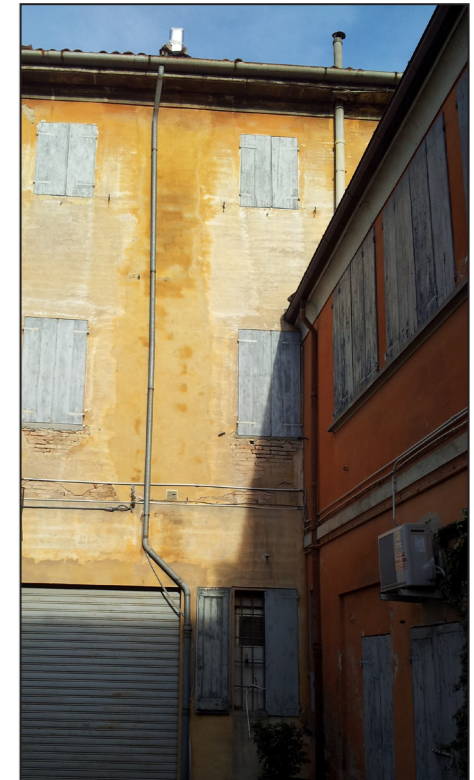
G. Vista della connessione tra l'edificio I e IV. Dall'esterno non si riscontrano particolari problemi, ma all'interno si sono verificati danni da mancanza di ammassamento tra i due fabbricati.
