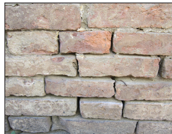
Figura 7.10.2.1.5.: Edificio X, piano terra, particolare della malta assente.
