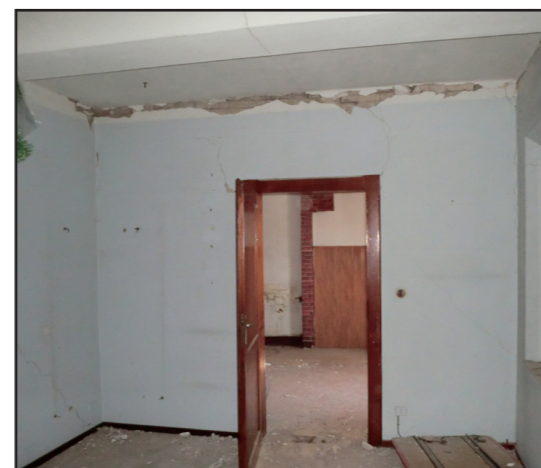
Figura 10.1.2.2.6.: Edificio I, appartamento 3, particolare delle lesioni ai tramezzi.
