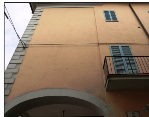
Figura 10.1.1.3.: Edificio I, portico, particolare delle lesioni a taglio.
