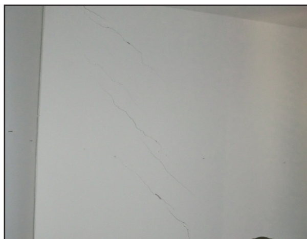
Figura 10.1.2.2.5.: Edificio I, appartamento 3, particolare delle lesioni a taglio.
