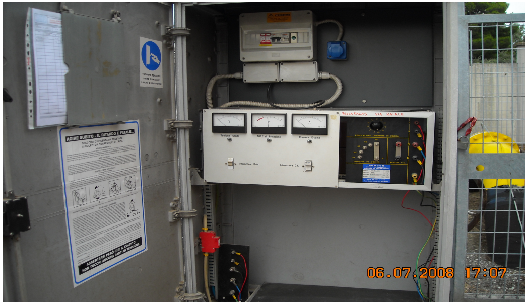
Figura 4.6. Impianto di protezione catodica
