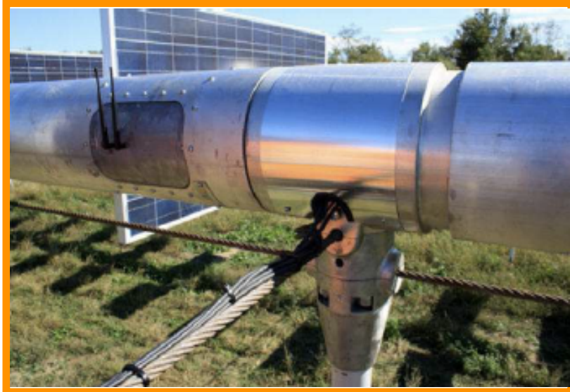
Figura 31 - Sistema di controllo del tracker
