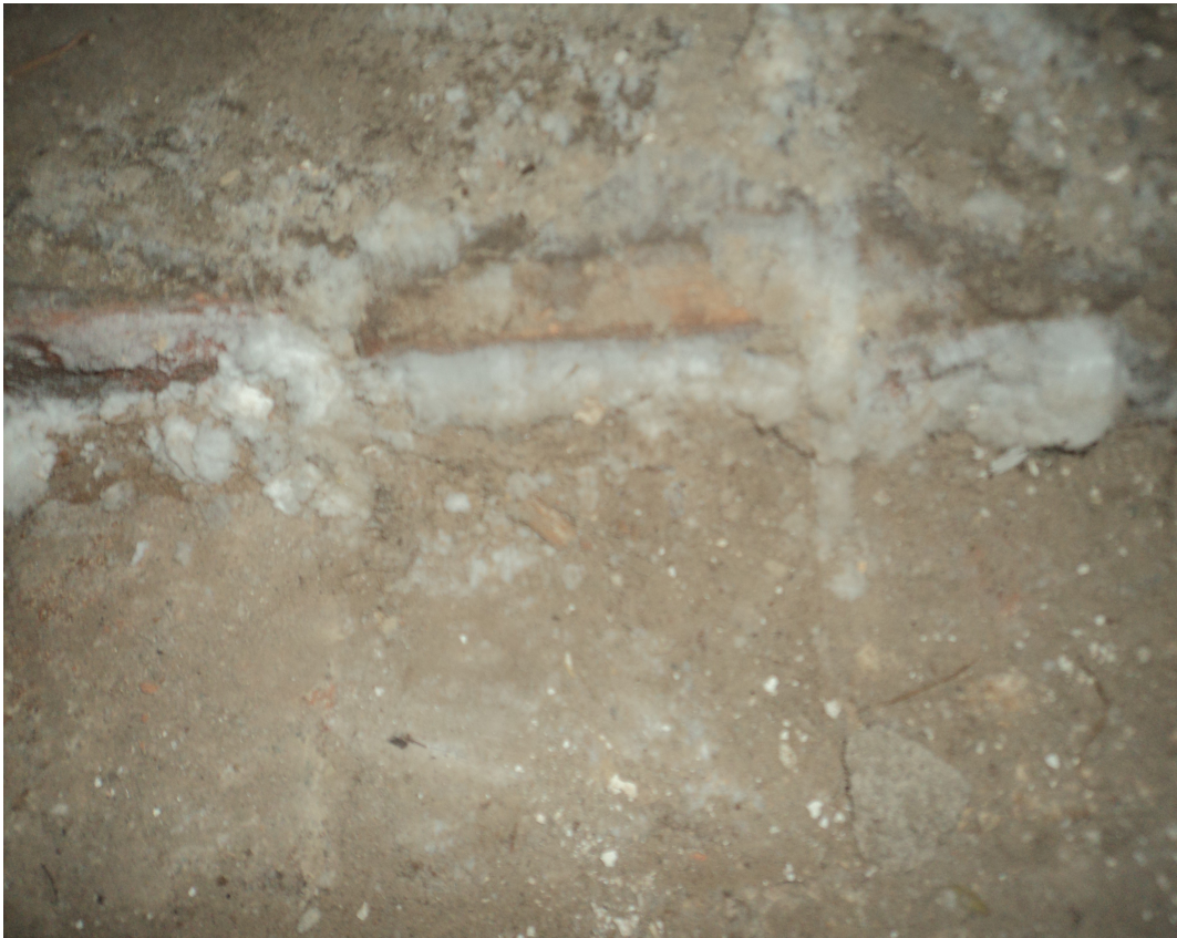
Figura 44: Campione n° 2, Efflorescenze saline
