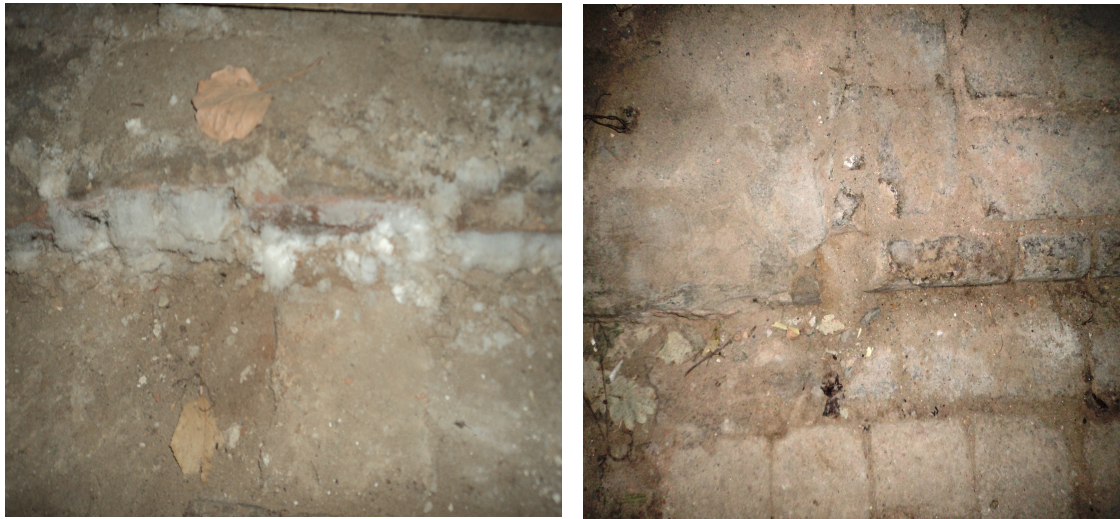
Figure 82: Efflorescenze saline e Disgregazione dei mattoni
