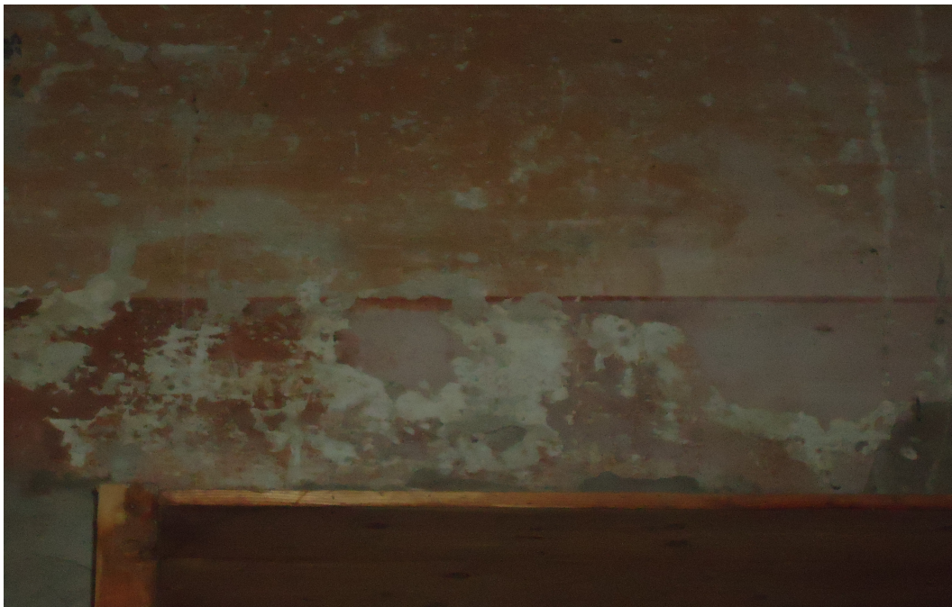
Figura 84: Distacchi dell'intonaco dalla parete e fessurazioni non passanti
