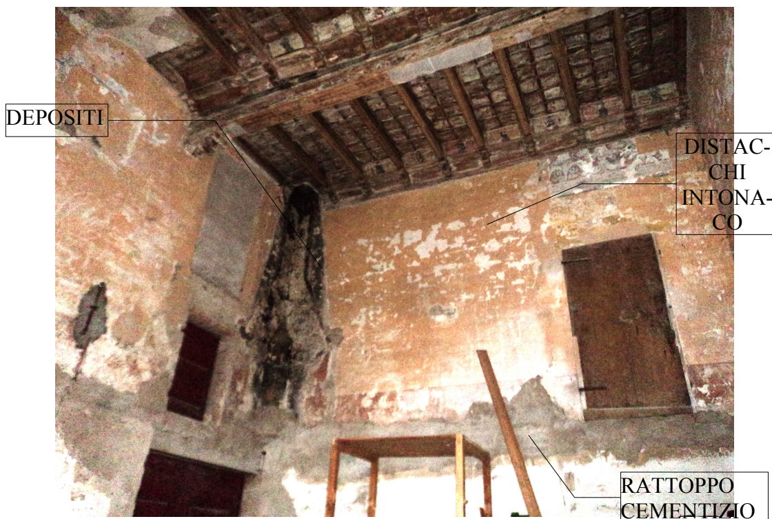
Figura 91: Meccanismi di degrado sulla parete D
