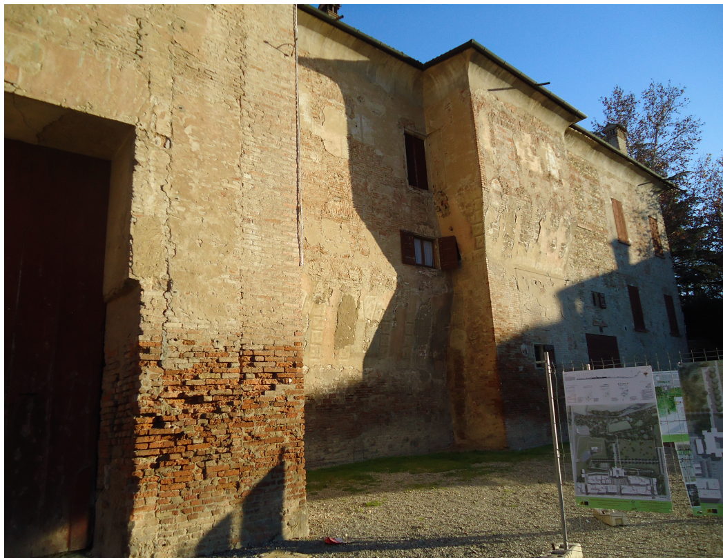
Figura 10 : Lacerti d'intonaco decorato sul prospetto ovest
