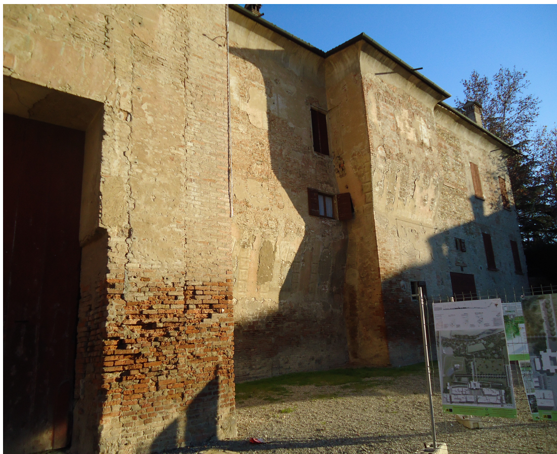
Figura 41: Fascia scura parallela al terreno sull'ingresso del prospetto ovest
