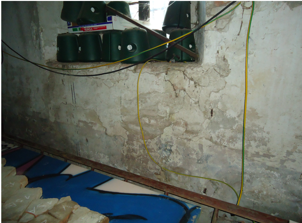
Figura 86: Distacchi dell'intonaco nella parte inferiore della parete
