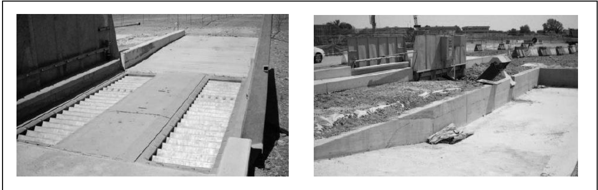
fig. 30: impianto di lavaggio ruote e vasca di scarico.
