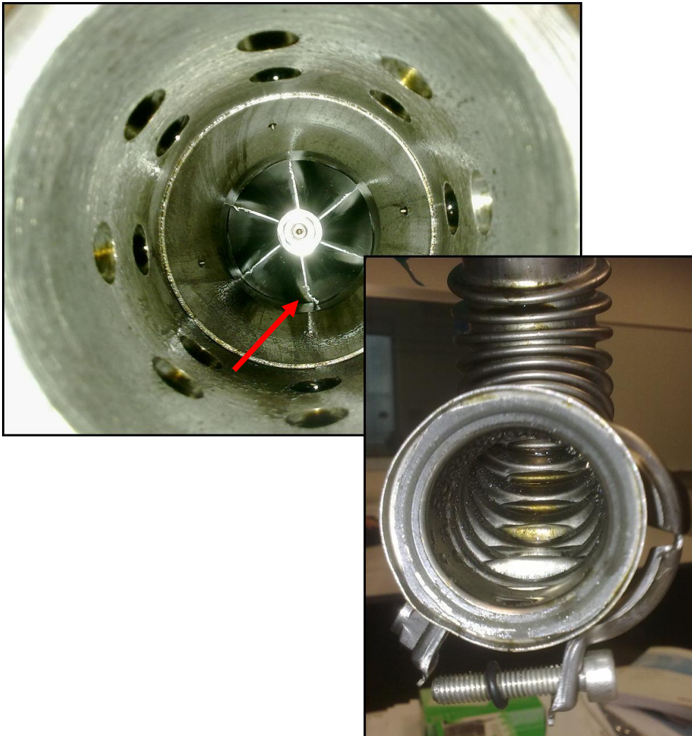
Fig.1 Erosione della superficie delle palette rotoriche del compressore
