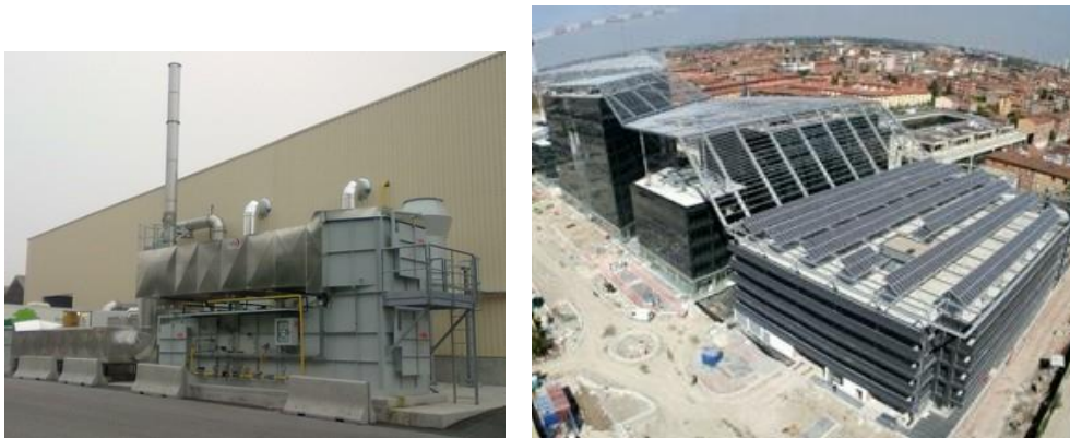
Figura 2.2. Impianto di post-combustione termica con recupero calore e impianto fotovoltaico [14].
