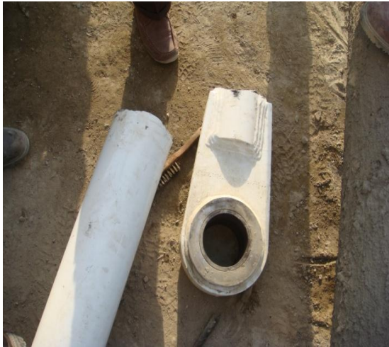
Terminale e tubo dopo rottura
