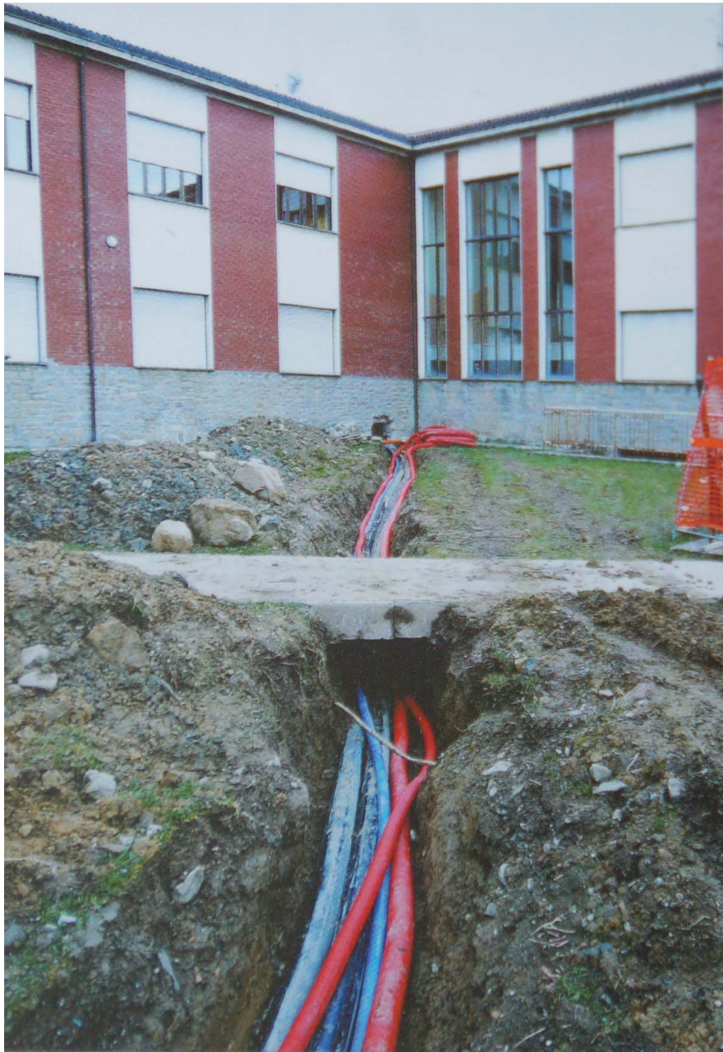
Rete di teleriscaldamento
