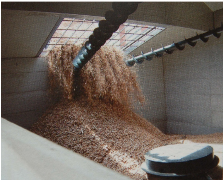
Caricamento del silos con il cippato
