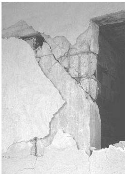
Figura 2.4: Esempio di rottura per taglio di una colonna sottoposta ad azione sismica.
