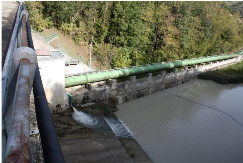
Figura 3.3 - Il rilascio del DMV e la tubatura della turbina
