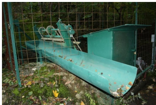
Figura 3.14 - Scarico dello sgrigliato
