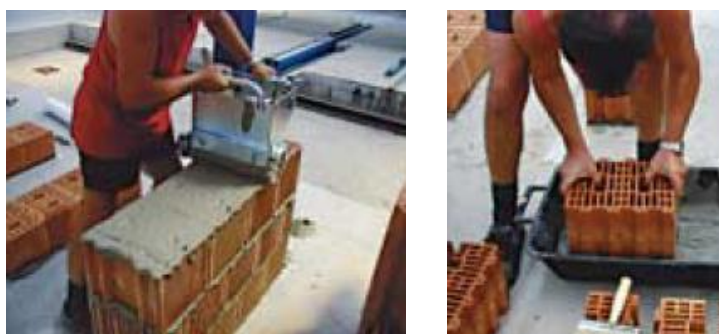
Fig. 5.3.8 – Tecnica per stesura della malta con rullo stendigiunto (a sinistra) e per immersione (a destra)
