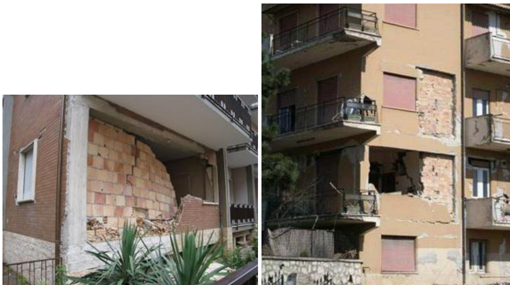
Fig. 2.2.3 – Tamponamenti lesionati con successiva espulsione dello strato esterno
