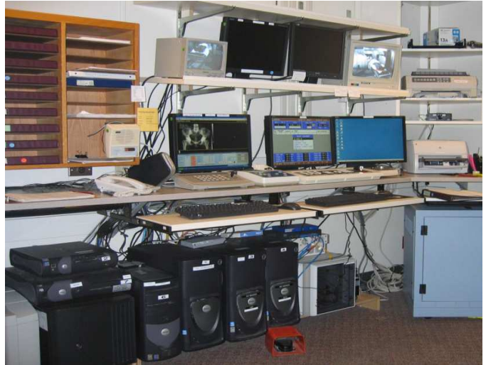
LINAC - Posto di comando
