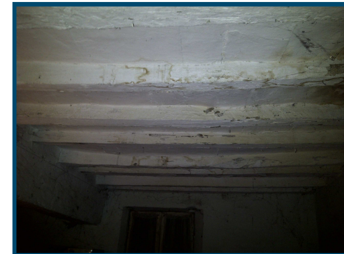
Inflessione travetti e infiltrazioni d'acqua
