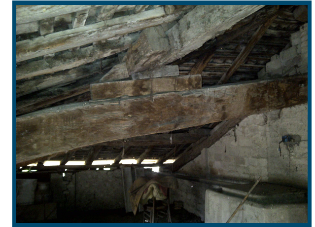
Degrado della struttura di copertura
