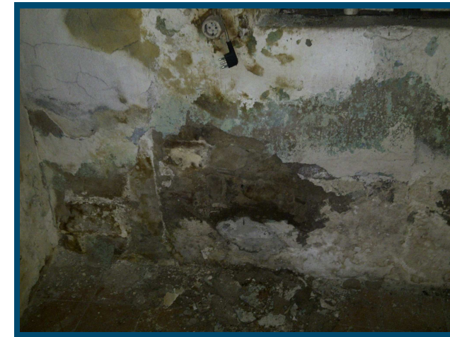
Umidità di risalita
