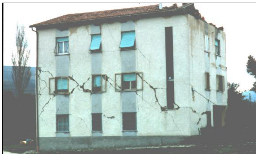
Fig. 1.2 – Edificio ad uso residenziale dopo l'evento sismico in Molise del 2002
