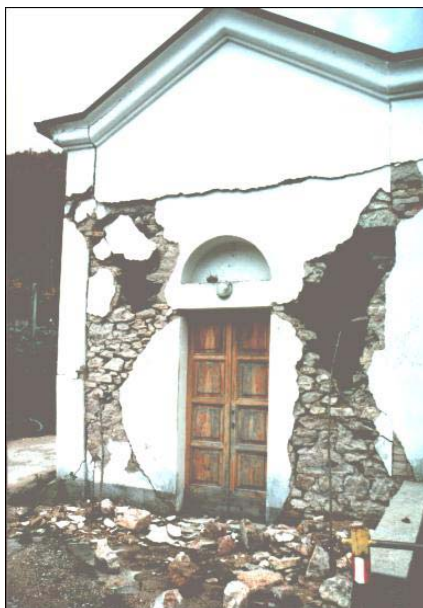
Fig. 1.3 – Chiesa del Molise dopo l'evento sismico del 2002
