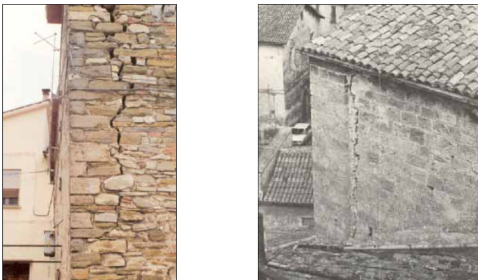
Fig. 1.14 - Esempi di danni dovuti a carenza di ammorsamento.
