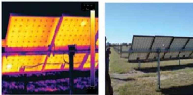
Figura 6.2.4.f - Foto del lato posteriore di un pannello fotovoltaico
