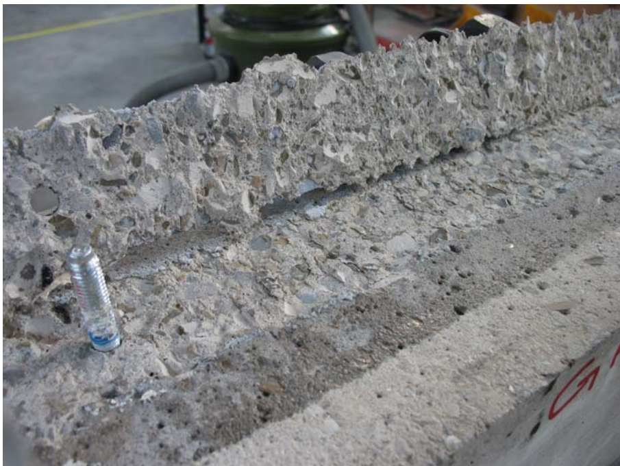
Figura 3.20.5 Particolare superficie delaminata
