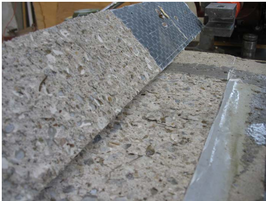
Figura 3.6.4 Particolare superficie delaminata
