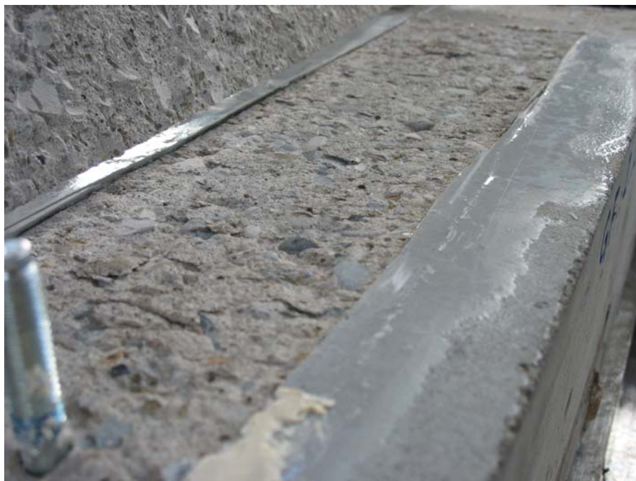
Figura 3.11.6 Particolare superficie delaminata
