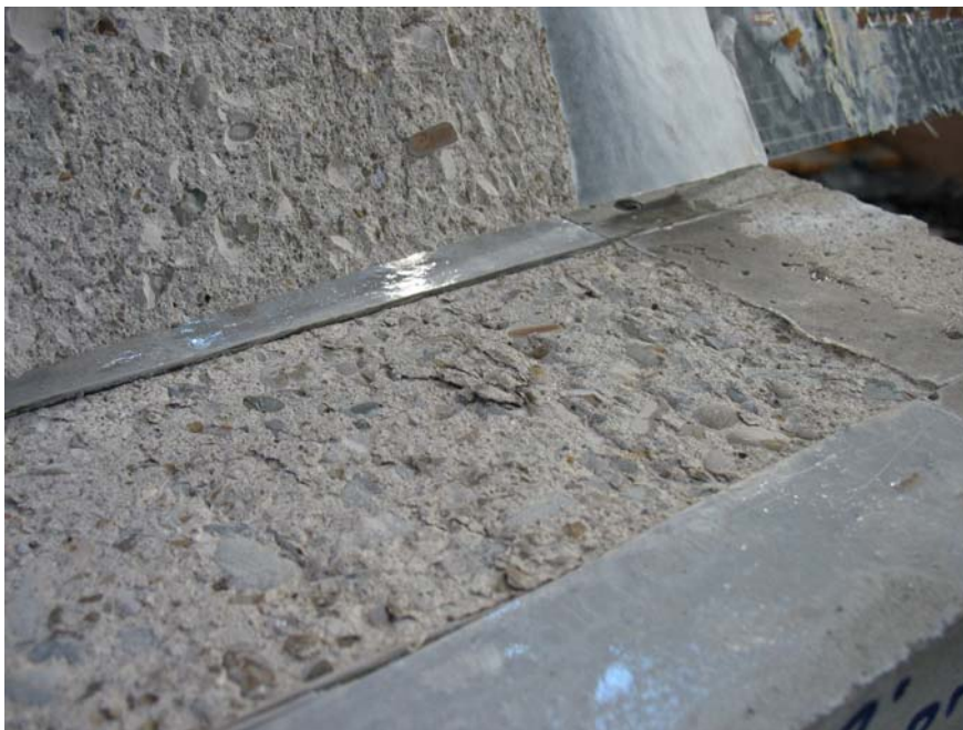
Figura 3.11.4 Particolare superficie delaminata
