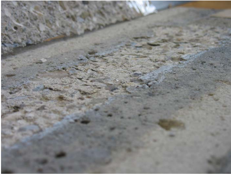
Figura 3.18.5 Particolare superficie delaminata
