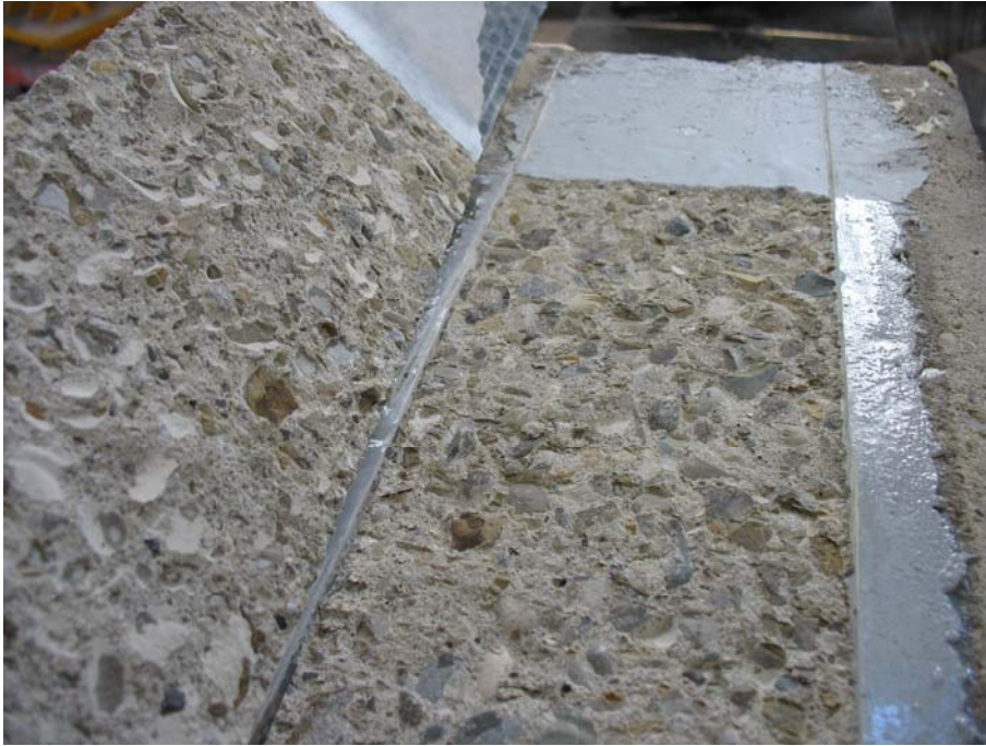
Figura 3.9.4 Particolare superficie delaminata
