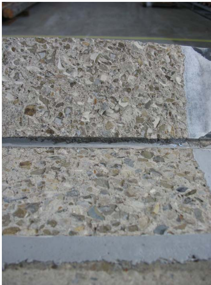
Figura 3.9.5 Particolare superficie delaminata
