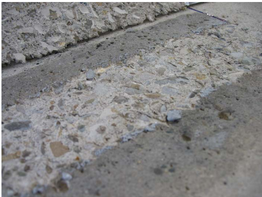
Figura 3.16.4 Particolare superficie delaminata
