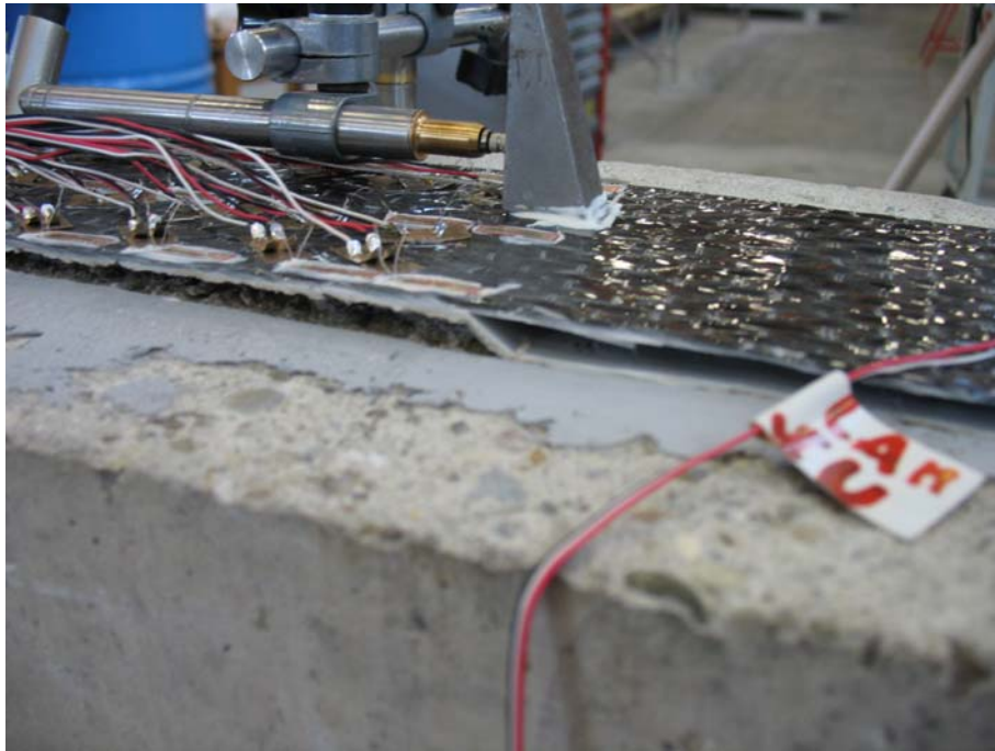
Figura 3.7.4 Particolare superficie delaminata
