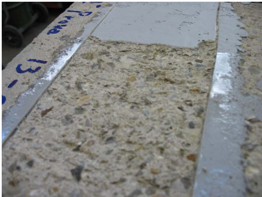
Figura 3.7.5 Particolare superficie delaminata
