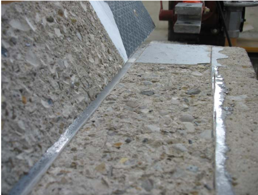
Figura 3.3.4 Particolare superficie delaminata
