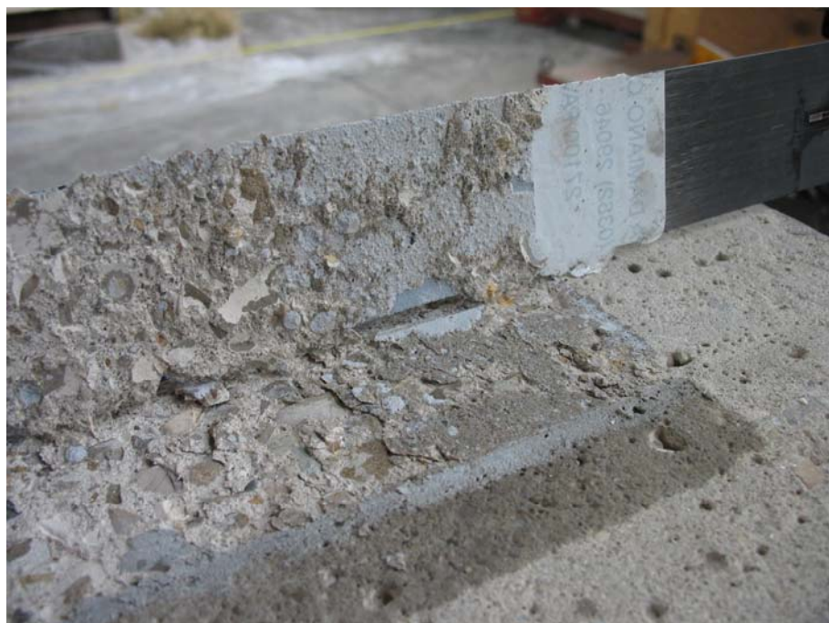
Figura 3.25.5 Particolare superficie delaminata
