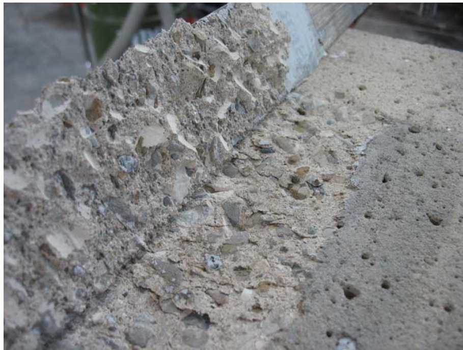
Figura 3.21.4 Particolare superficie delaminata
