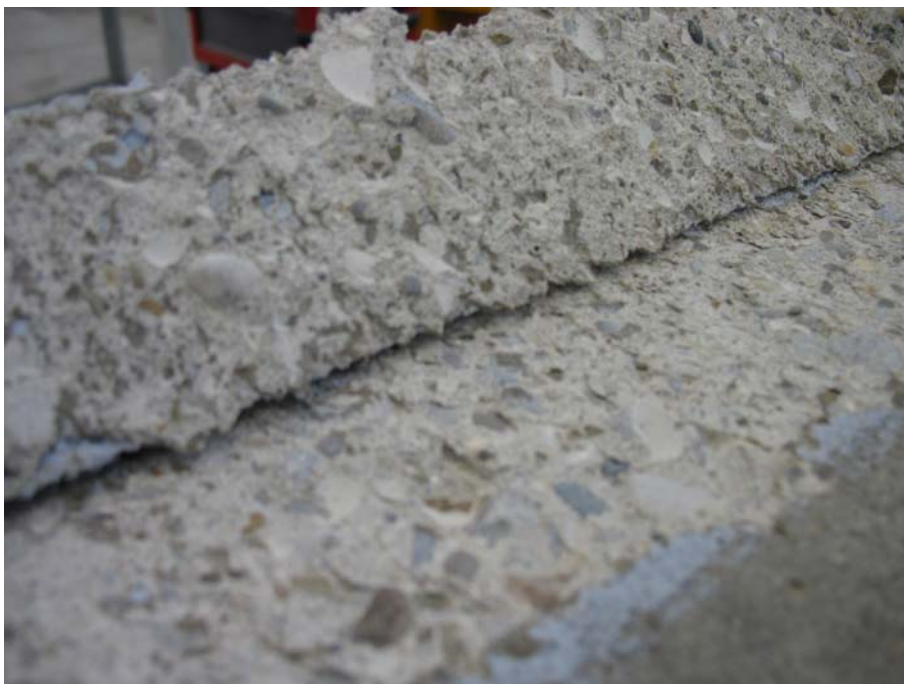
Figura 3.17.5 Particolare superficie delaminata
