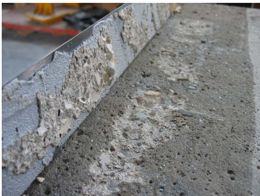
Figura 3.24.7 Particolare superficie delaminata
