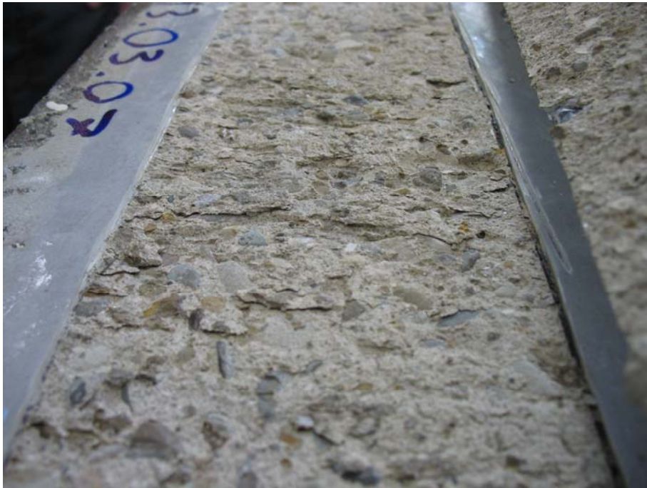
Figura 3.2.5 Particolare superficie delaminata
