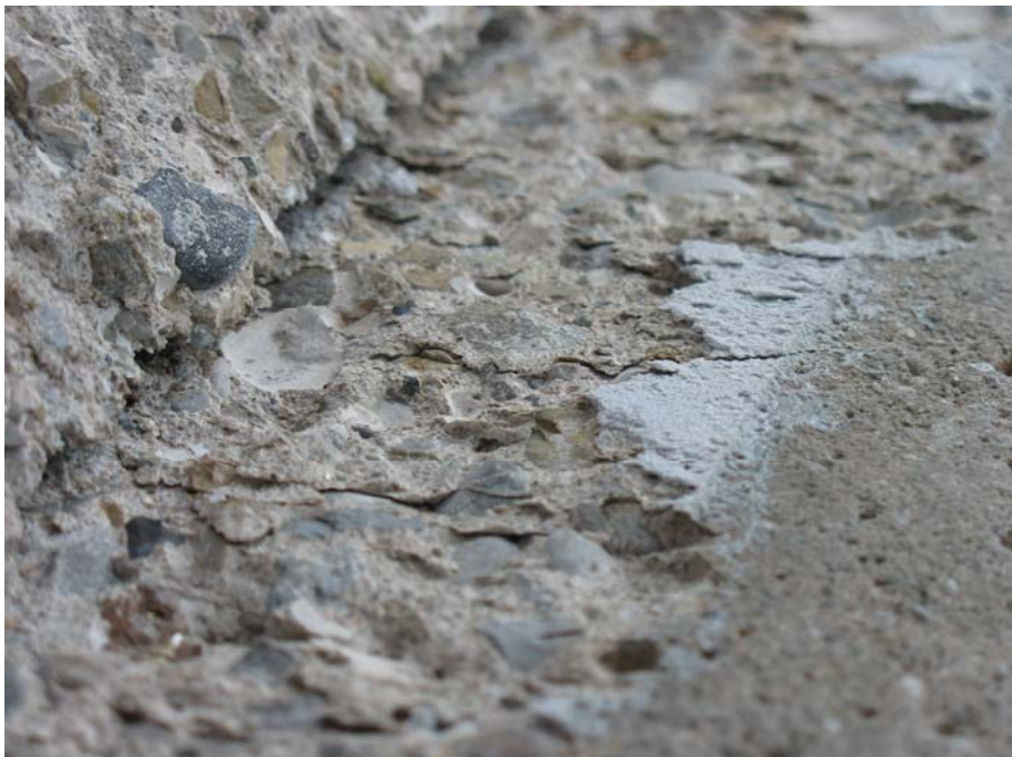
Figura 3.28.5 Particolare superficie delaminata
