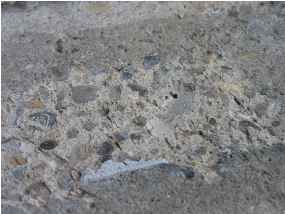
Figura 3.14.5 Particolare superficie delaminata
