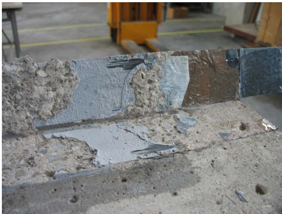
Figura 3.29.6 Particolare superficie delaminata
