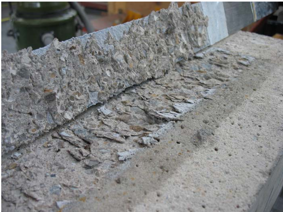
Figura 3.15.5 Particolare superficie delaminata
