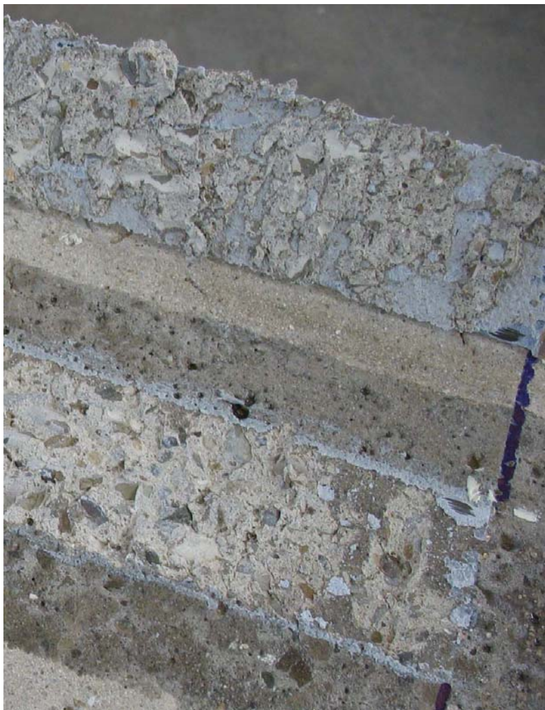
Figura 3.13.6 Particolare superficie delaminata
