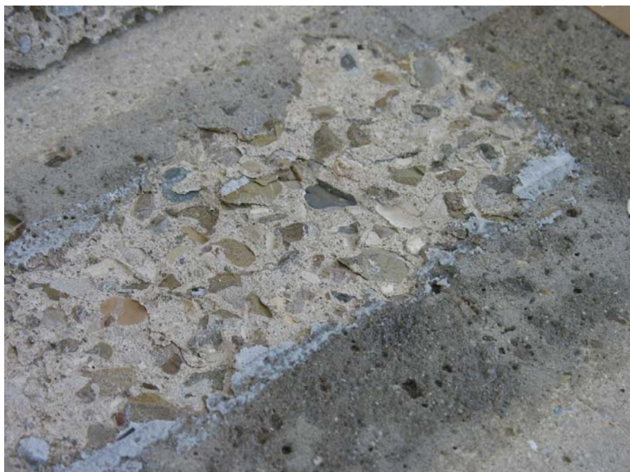
Figura 3.18.4 Particolare superficie delaminata
