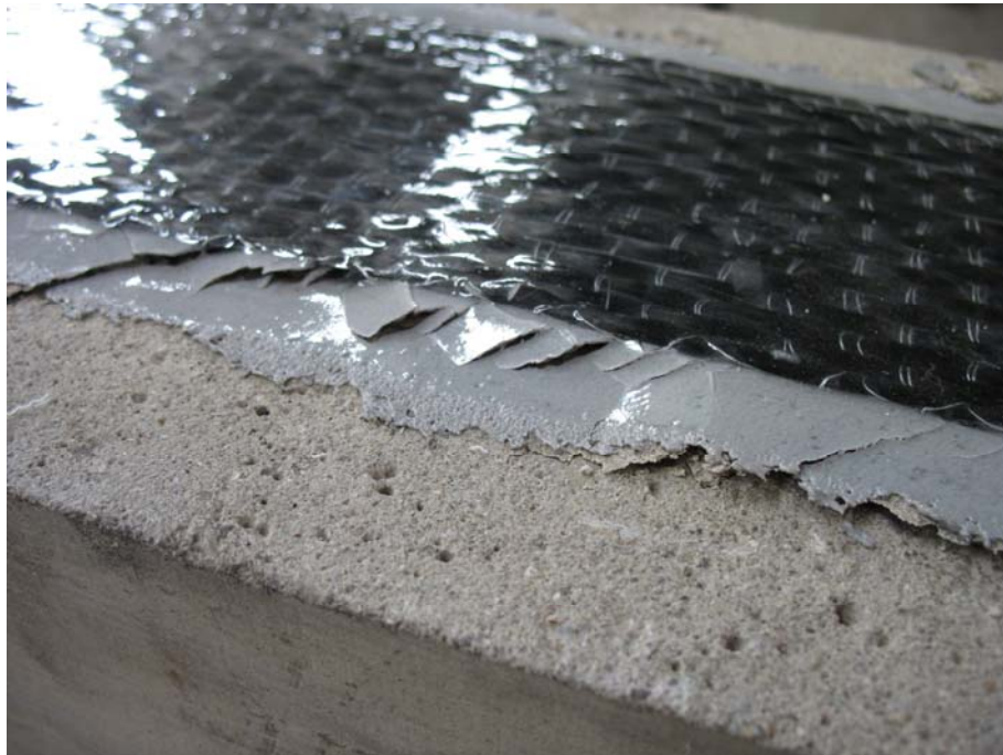
Figura 3.10.5 Particolare della delaminazione
