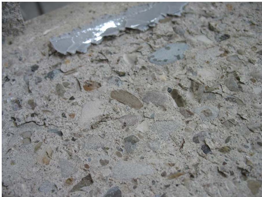
Figura 3.10.8 Particolare superficie delaminata
