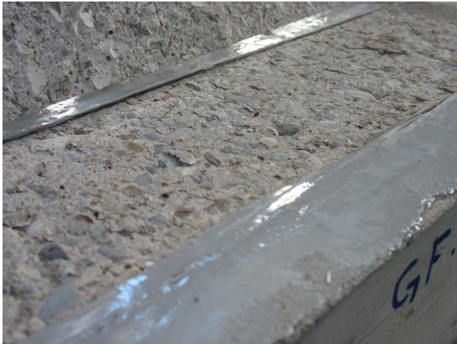
Figura 3.11.5 Particolare superficie delaminata
