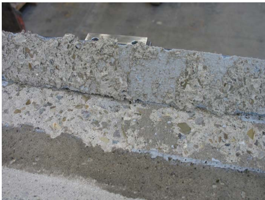
Figura 3.22.6 Particolare superficie delaminata
