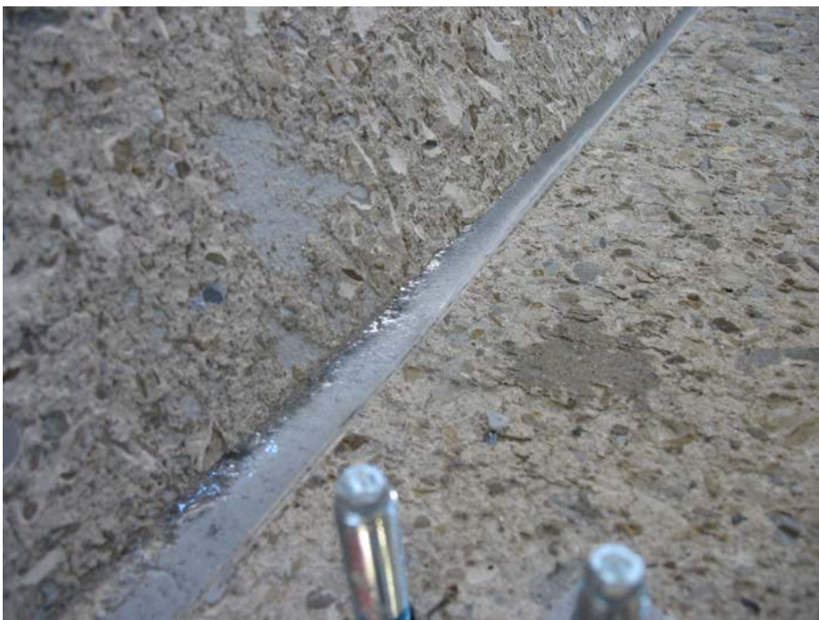
Figura 3.3.5 Particolare superficie delaminata
