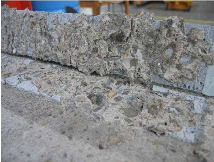
Figura 3.15.4 Particolare superficie delaminata
