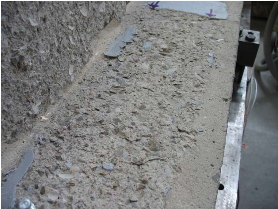
Figura 3.10.7 Particolare superficie delaminata
