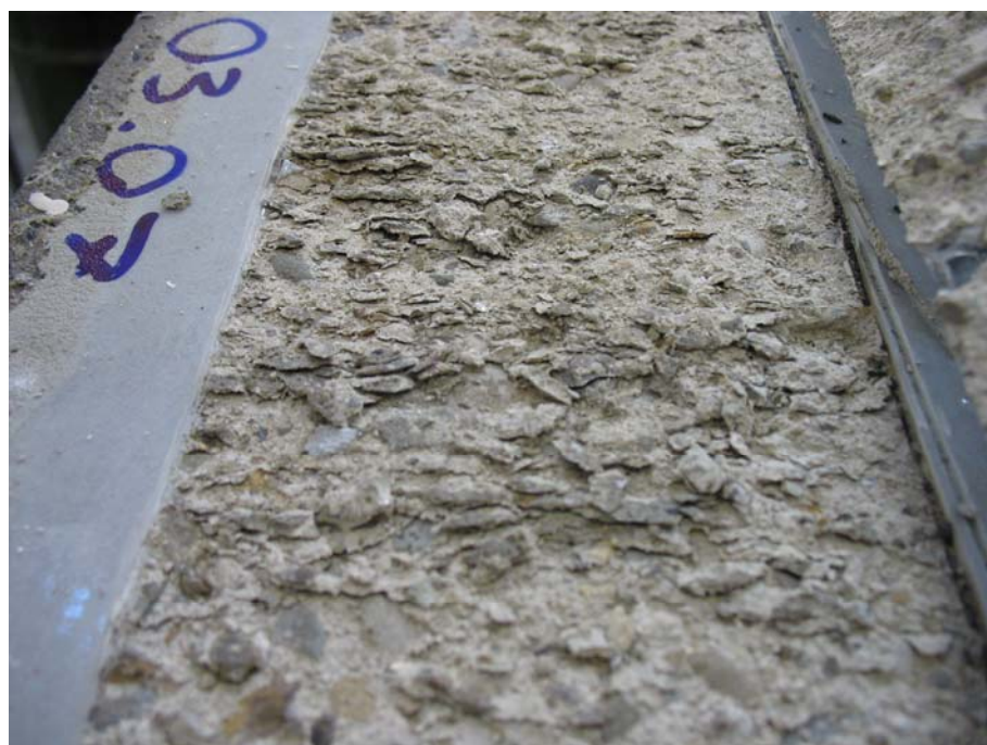
Figura 3.2.4 Particolare superficie delaminata
