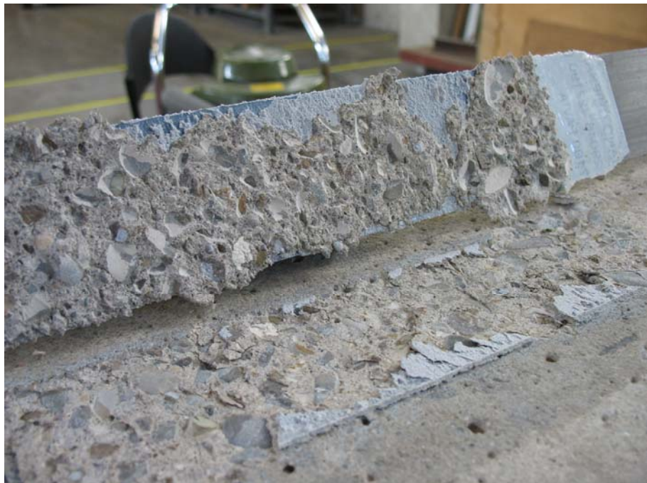
Figura 3.27.5 Particolare superficie delaminata
