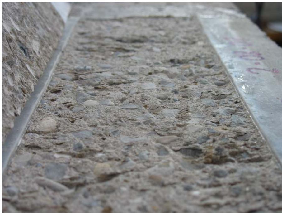
Figura 3.30.7 Particolare superficie delaminata
