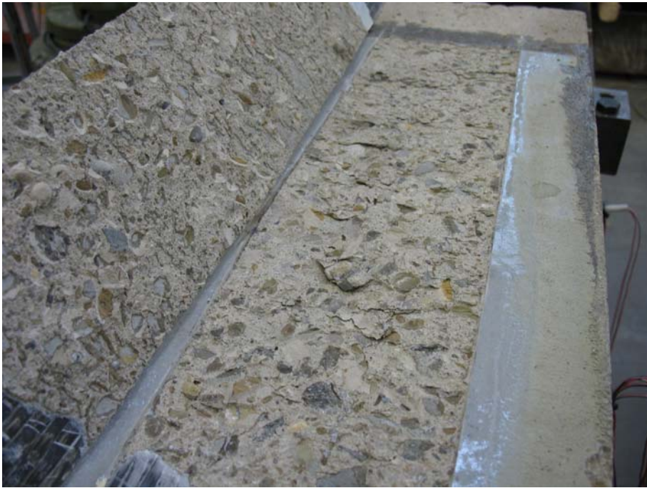
Figura 3.8.4 Particolare superficie delaminata
