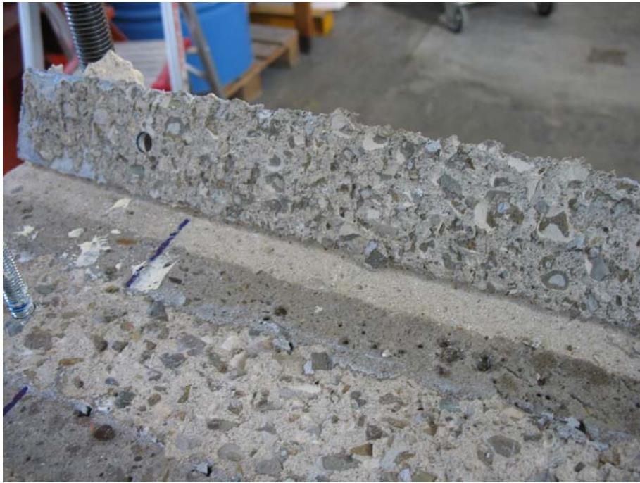
Figura 3.13.5 Particolare superficie delaminata
