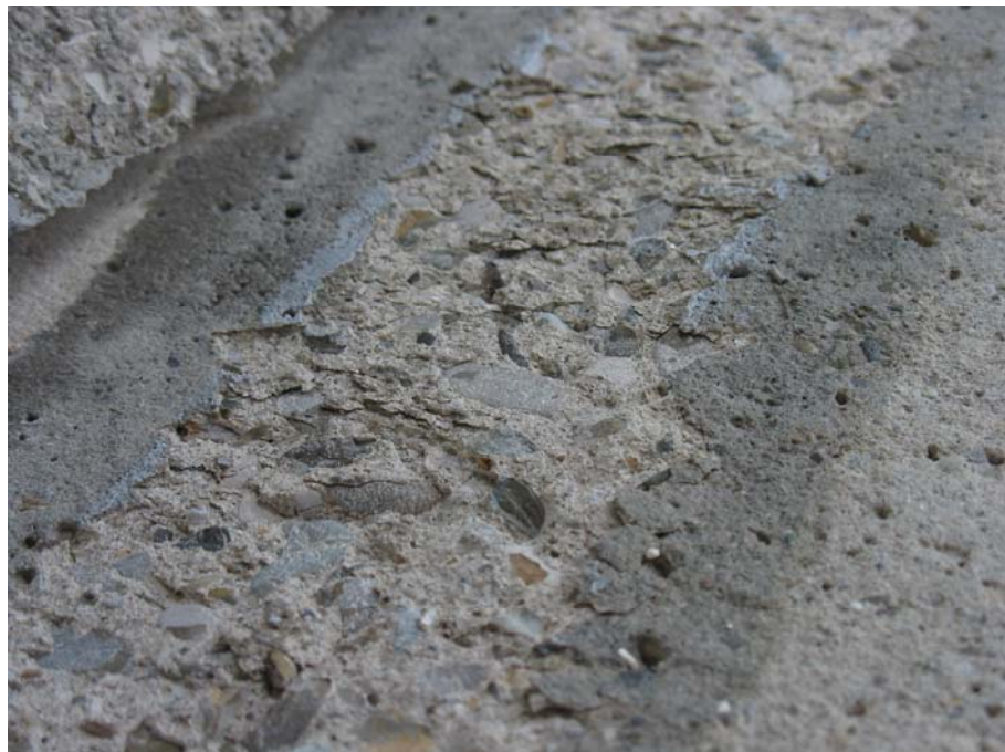
Figura 3.19.4 Particolare superficie delaminata
