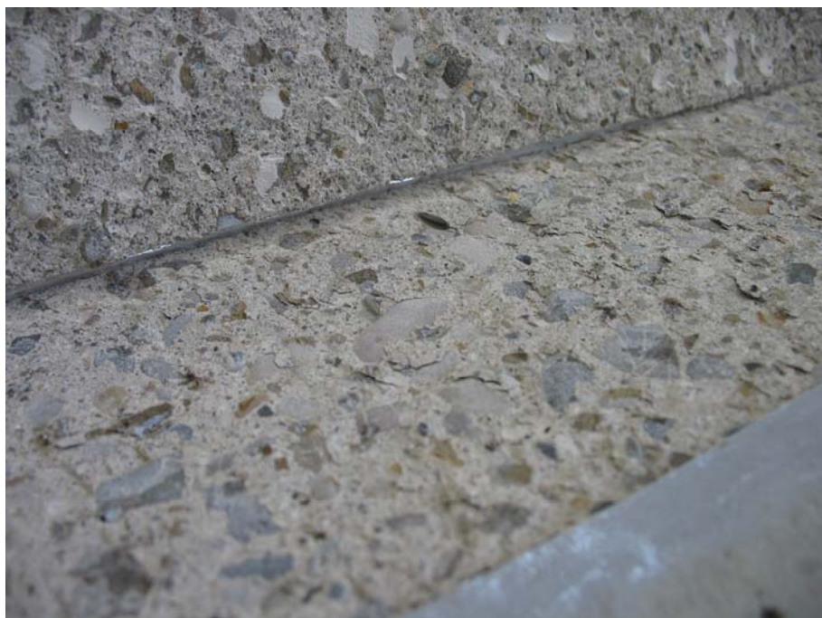
Figura 3.4.5 Particolare superficie delaminata
