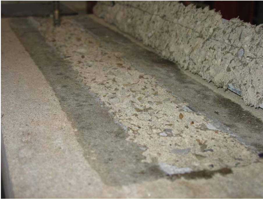
Figura 3.12.4 Particolare superficie delaminata
