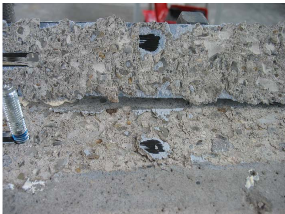
Figura 3.21.5 Particolare superficie delaminata
