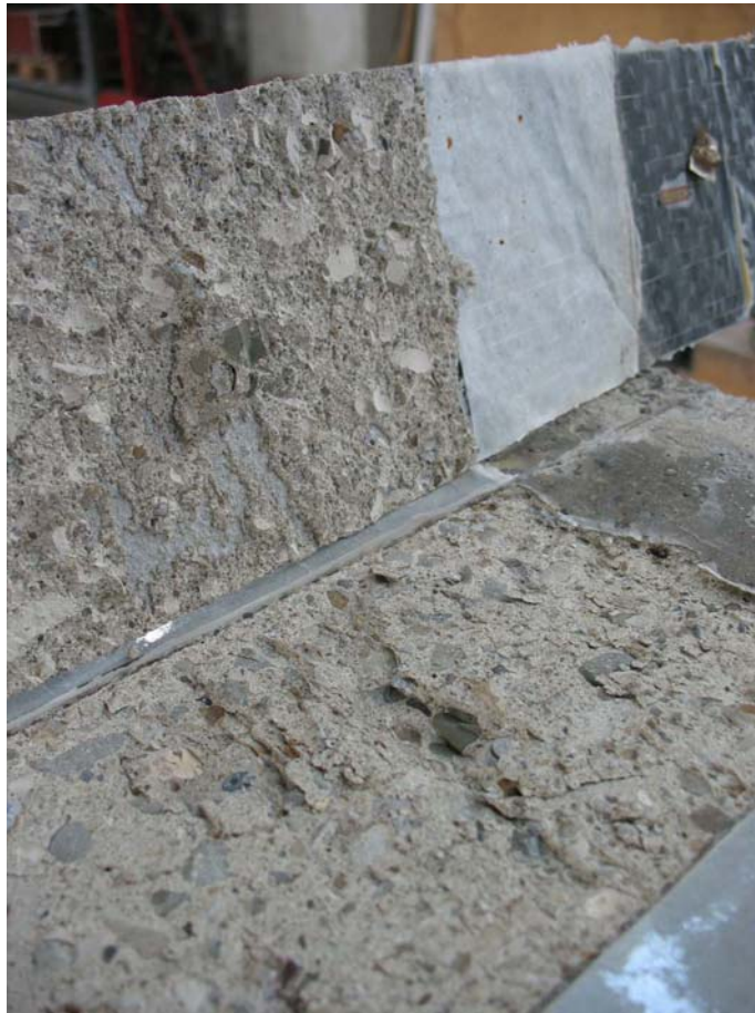
Figura 3.30.4 Particolare superficie delaminata
