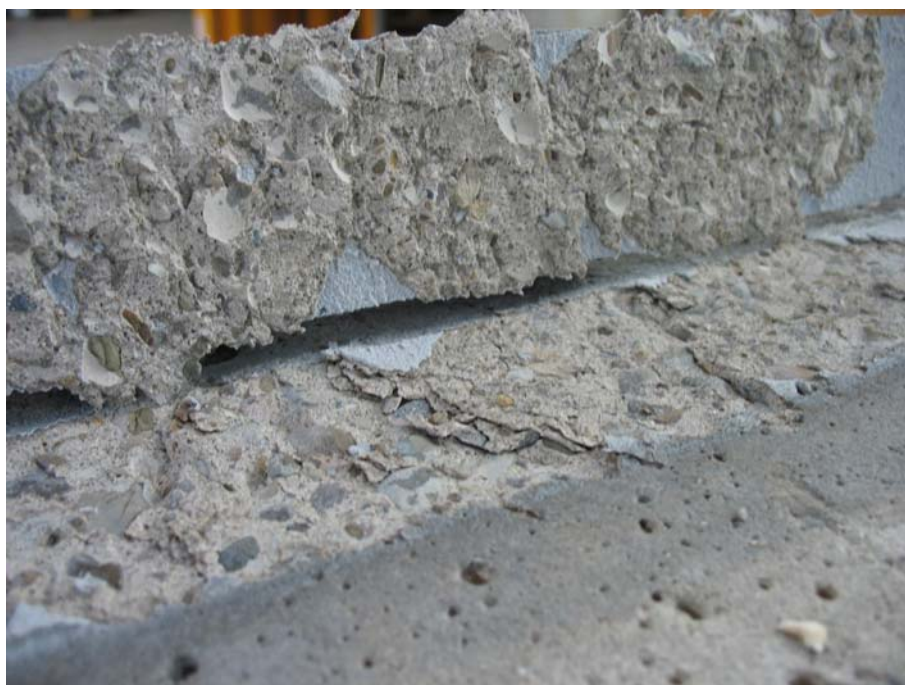
Figura 3.29.7 Particolare superficie delaminata
