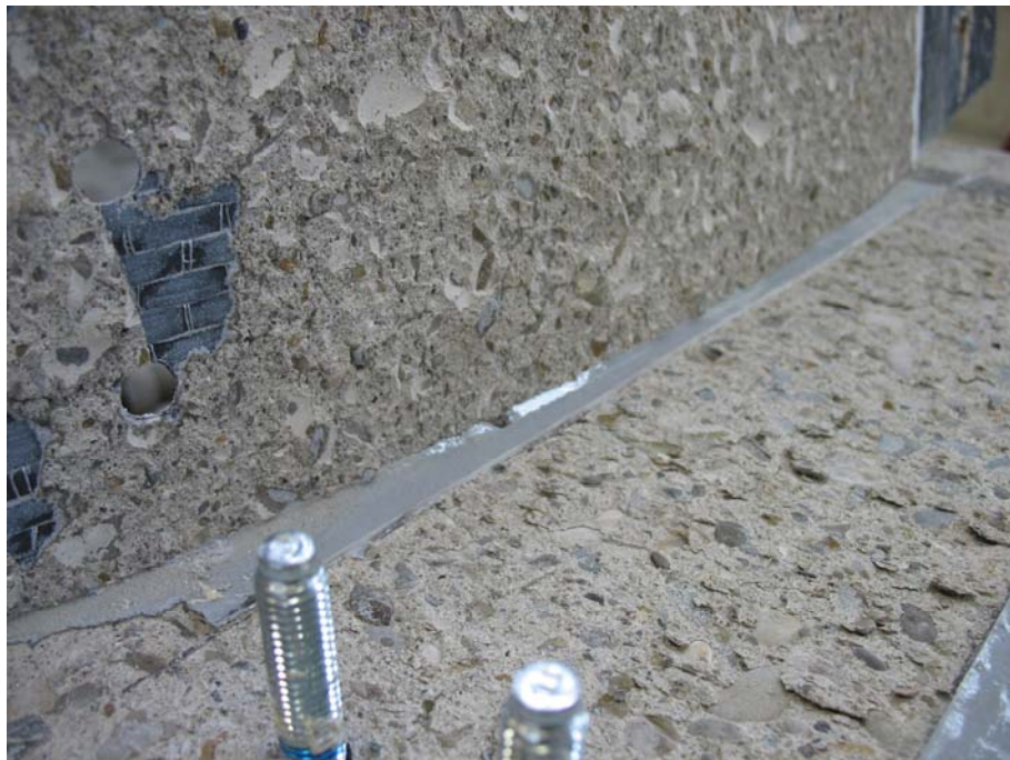
Figura 3.4.4 Particolare superficie delaminata
