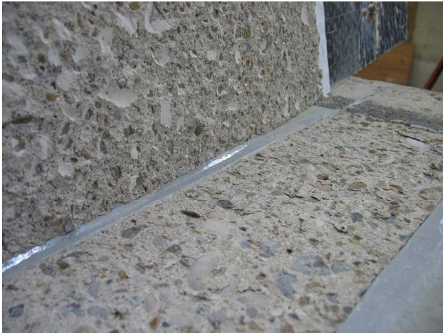
Figura 3.4.6 Particolare superficie delaminata
