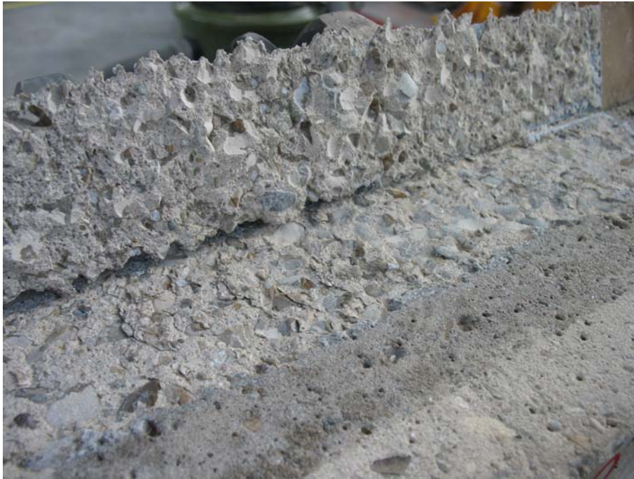
Figura 3.20.4 Particolare superficie delaminata
