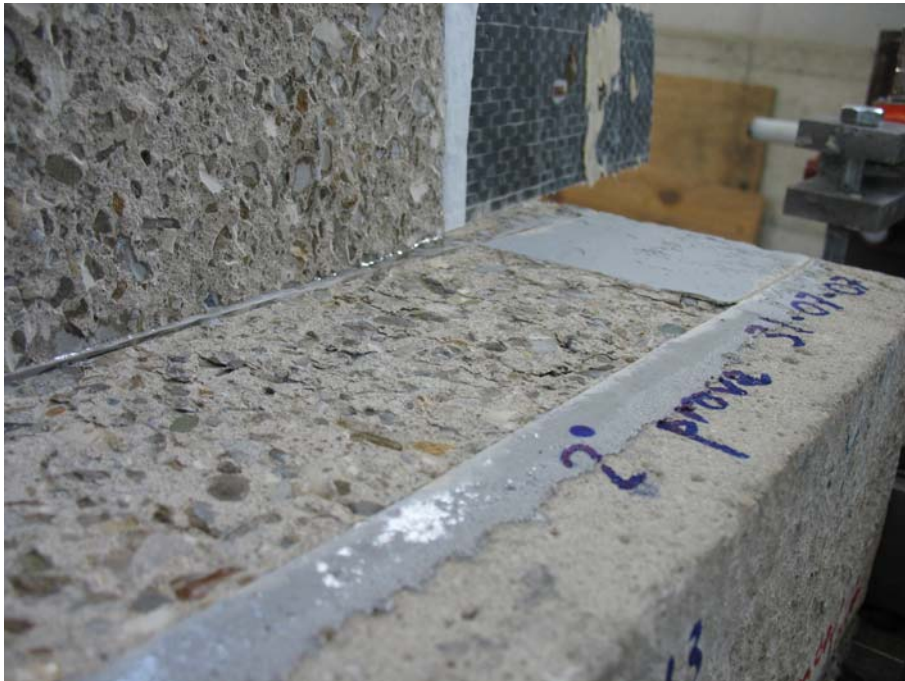
Figura 3.5.6 Particolare superficie delaminata
