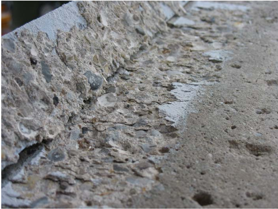
Figura 3.28.4 Particolare superficie delaminata
