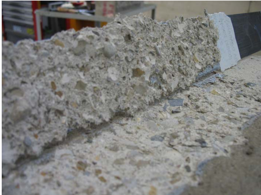
Figura 3.23.4 Particolare superficie delaminata
