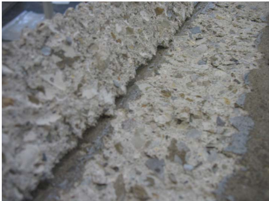
Figura 3.23.5 Particolare superficie delaminata
