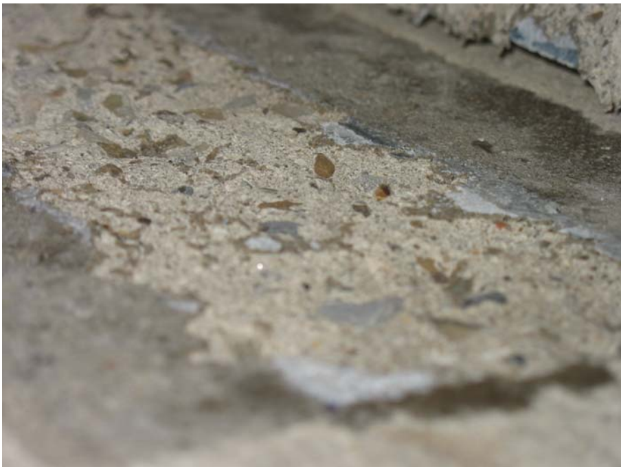
Figura 3.12.5 Particolare superficie delaminata
