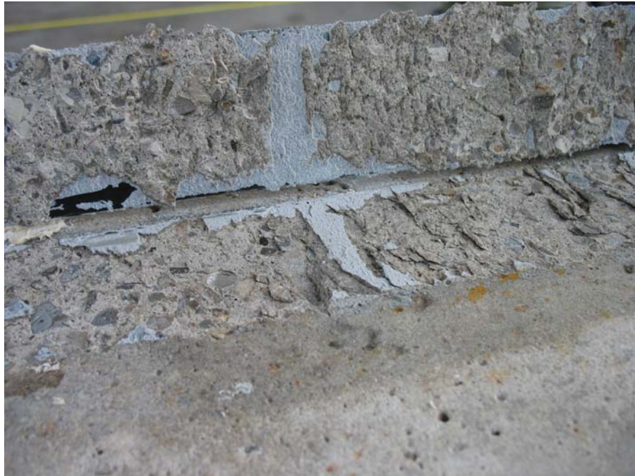
Figura 3.15.6 Particolare superficie delaminata
