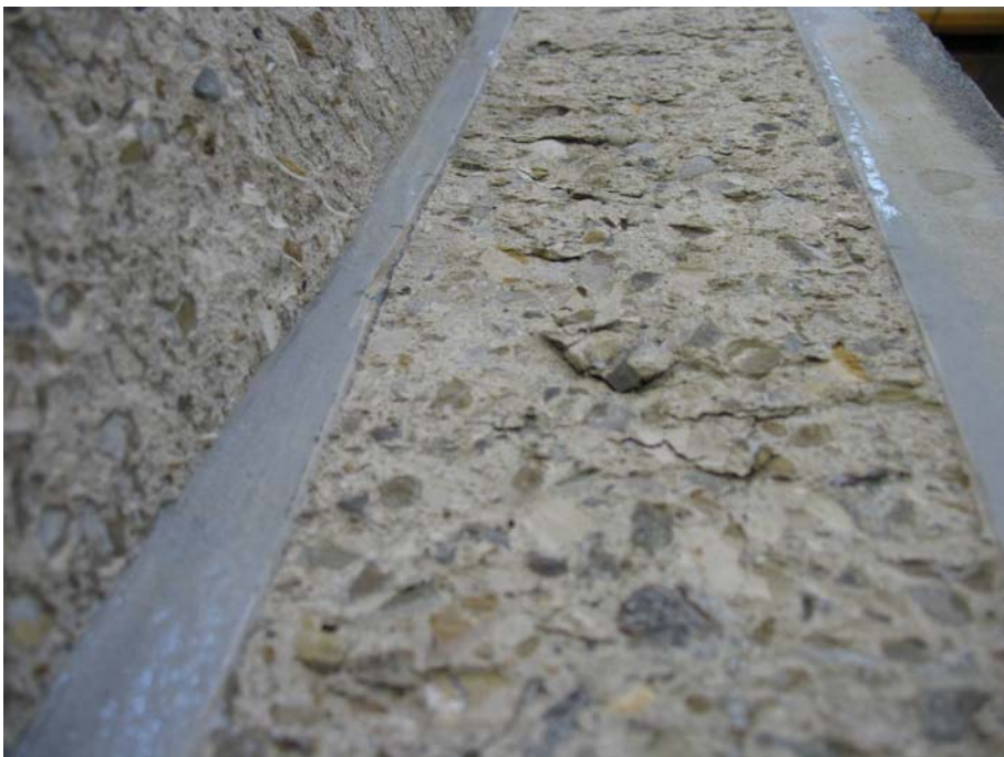
Figura 3.8.5 Particolare superficie delaminata
