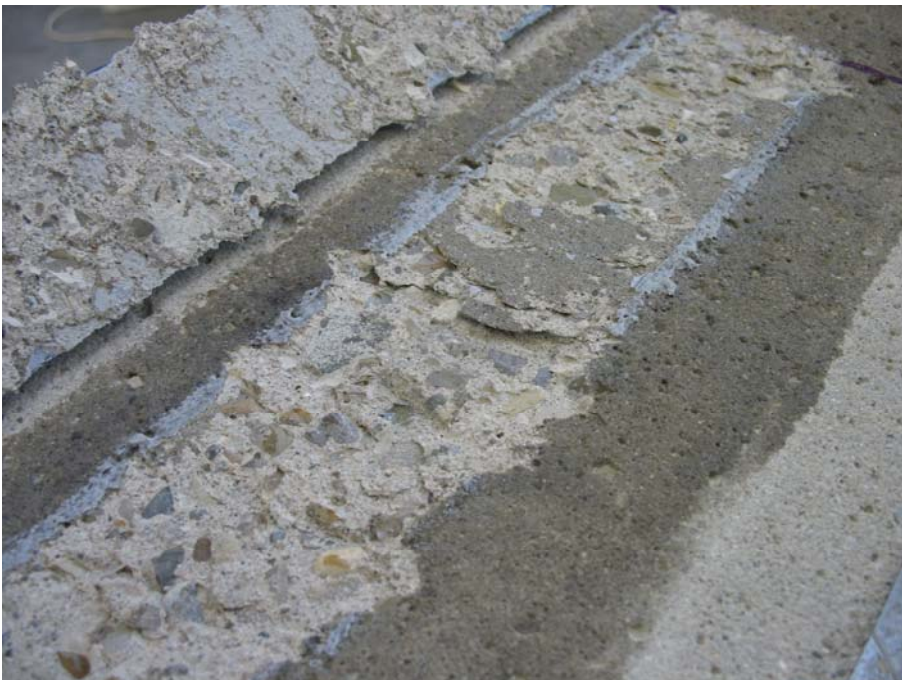
Figura 3.22.4 Particolare superficie delaminata
