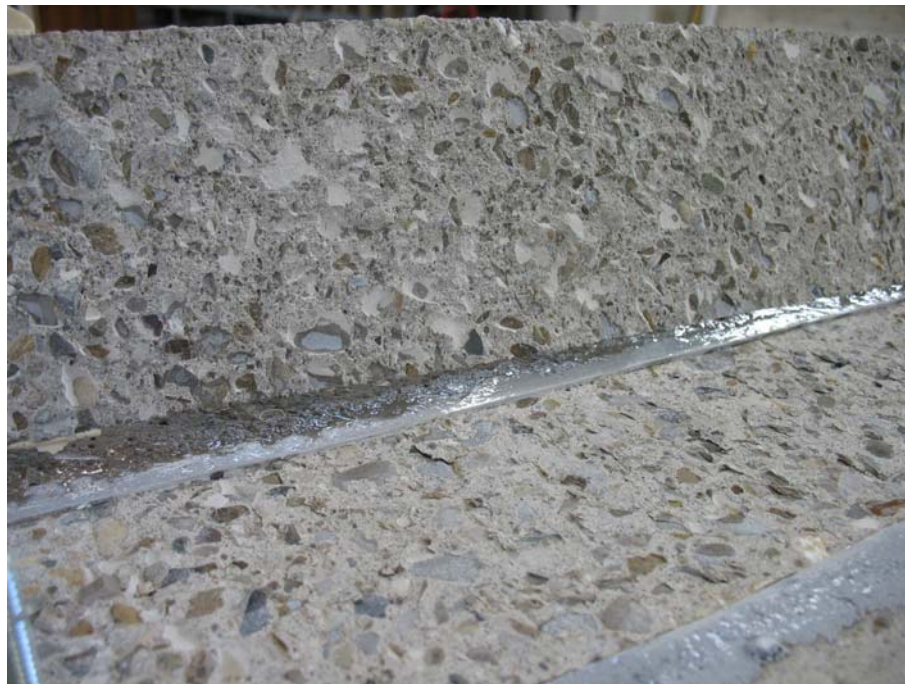
Figura 3.5.5 Particolare superficie delaminata
