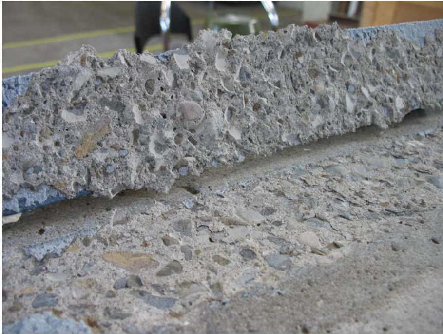
Figura 3.27.6 Particolare superficie delaminata
