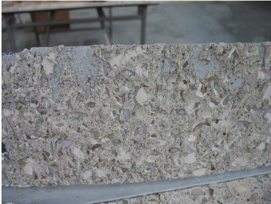
Figura 3.30.6 Particolare superficie delaminata
