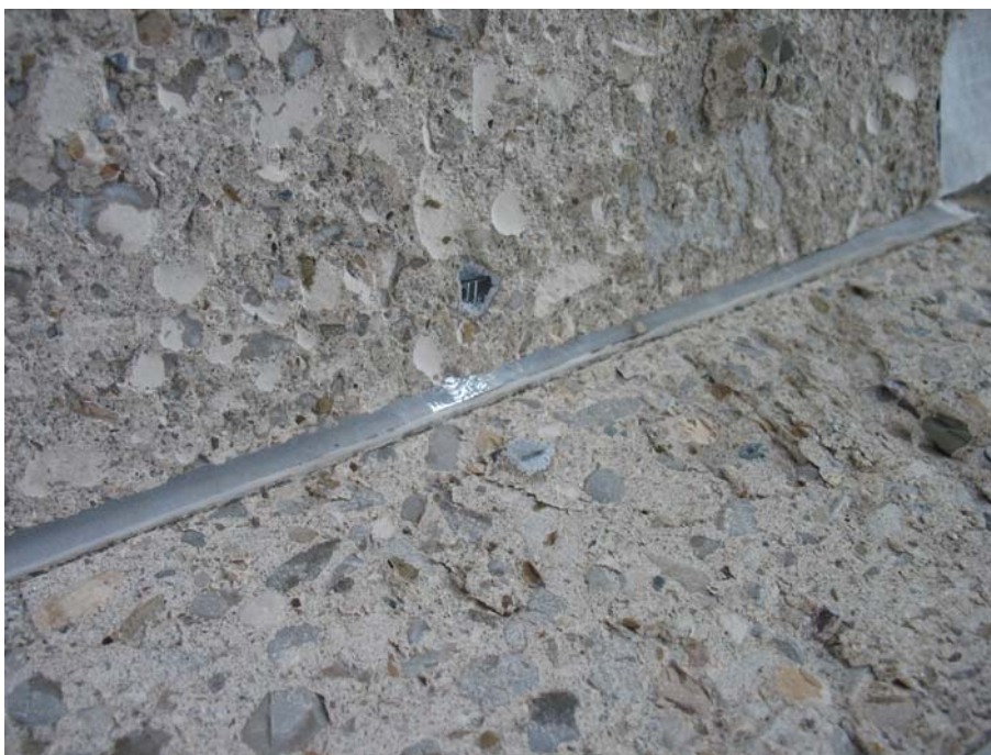
Figura 3.30.5 Particolare superficie delaminata
