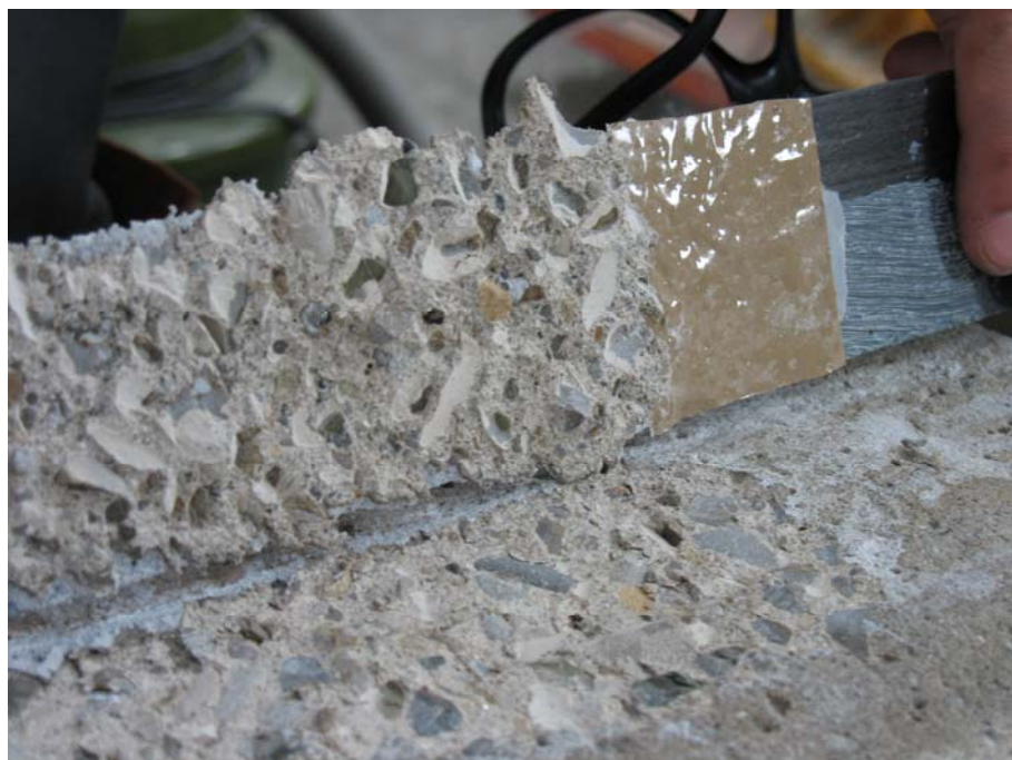
Figura 3.26.5 Particolare superficie delaminata
