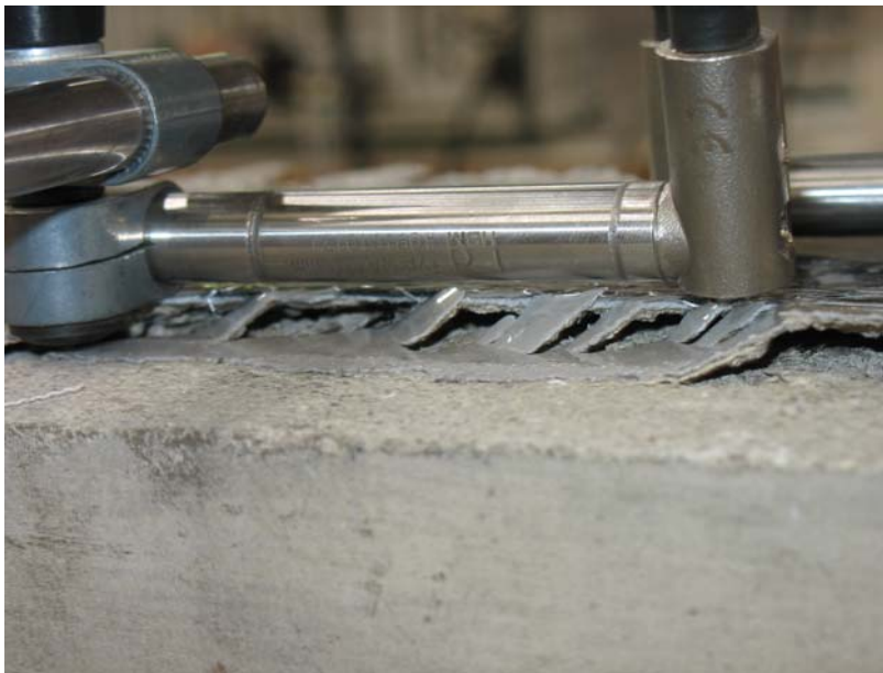
Figura 3.10.3 Particolare superficie delaminata
