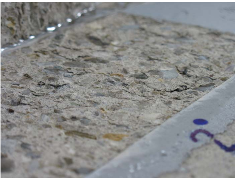
Figura 3.5.7 Particolare superficie delaminata
