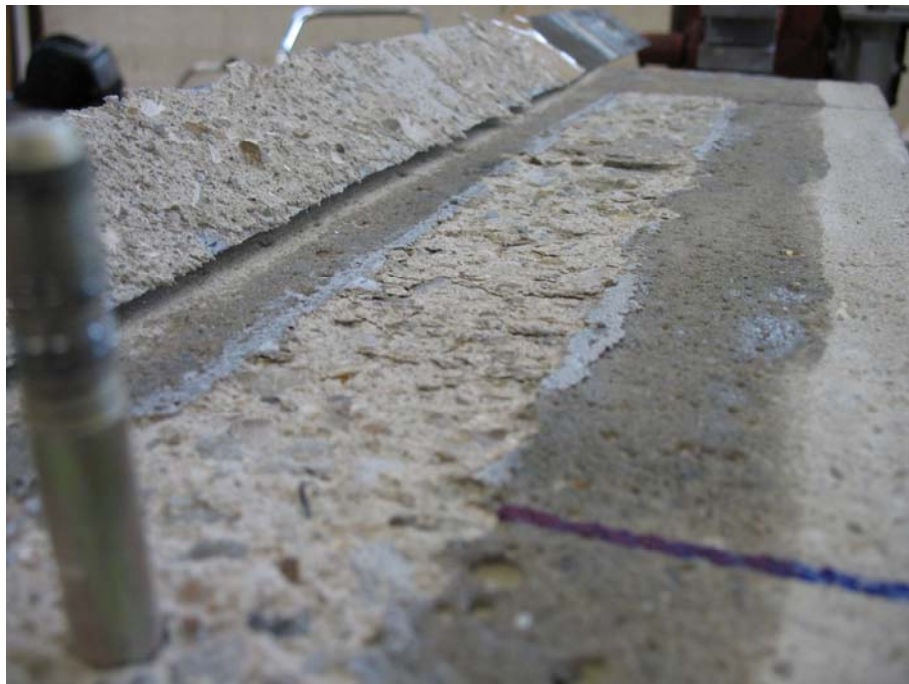
Figura 3.22.5 Particolare superficie delaminata
