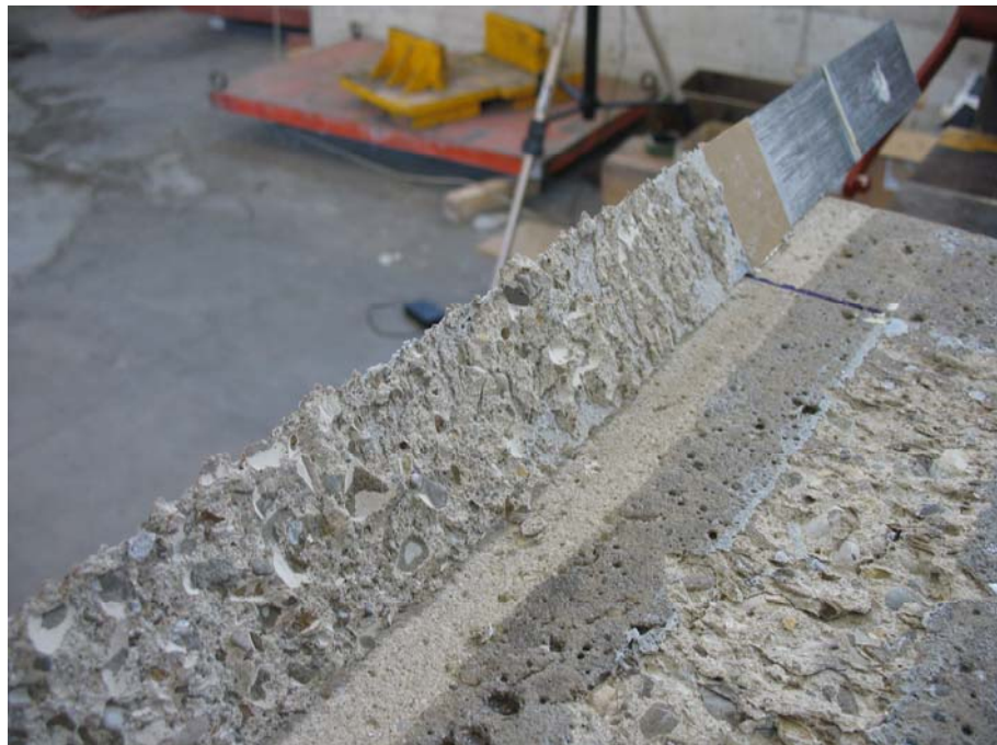
Figura 3.13.4 Particolare superficie delaminata
