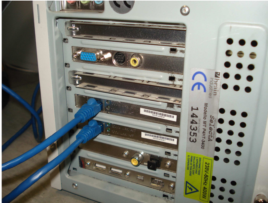
Figura 4.5: Particolare delle due schede di rete nelle quali vengono inseriti i cavi ethernet che arrivano dalle USRP2
