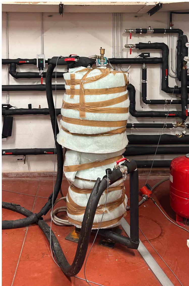
Figura 73. Sistema di accumulo con isolamento in lana di vetro
