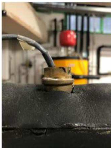
Figura 61. Pozzetto per inserire il sensore di temperatura
