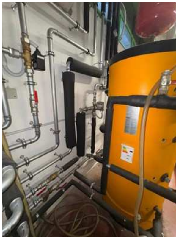
Figura 33. Foto reale dell'impianto lato destro
