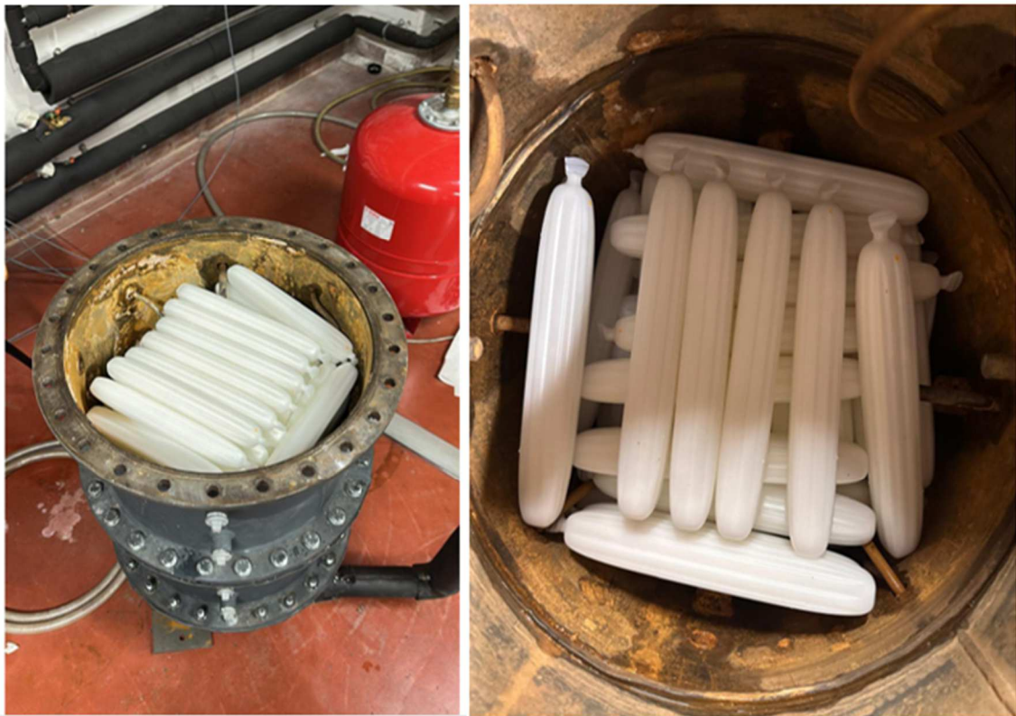
Figura 55. Disposizione dei moduli di ATS31 all'interno dell'accumulo
