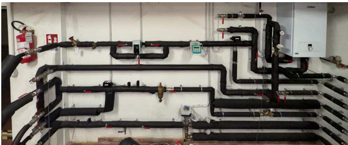
Figura 30. Foto reale dell'impianto lato sinistro
