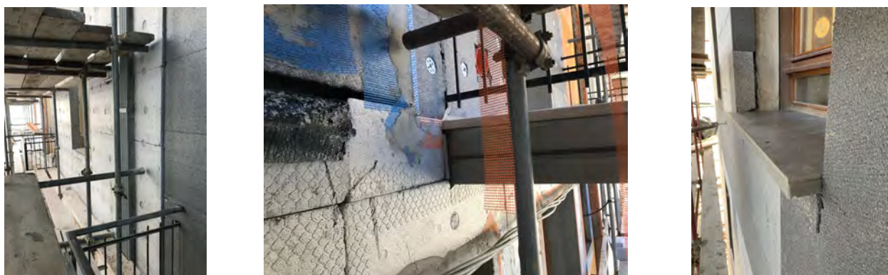
Fig.45 Documentazione fotografica di cantiere; MCA_6: XPS in corrispondenza delle aperture e delle travi di piano.
