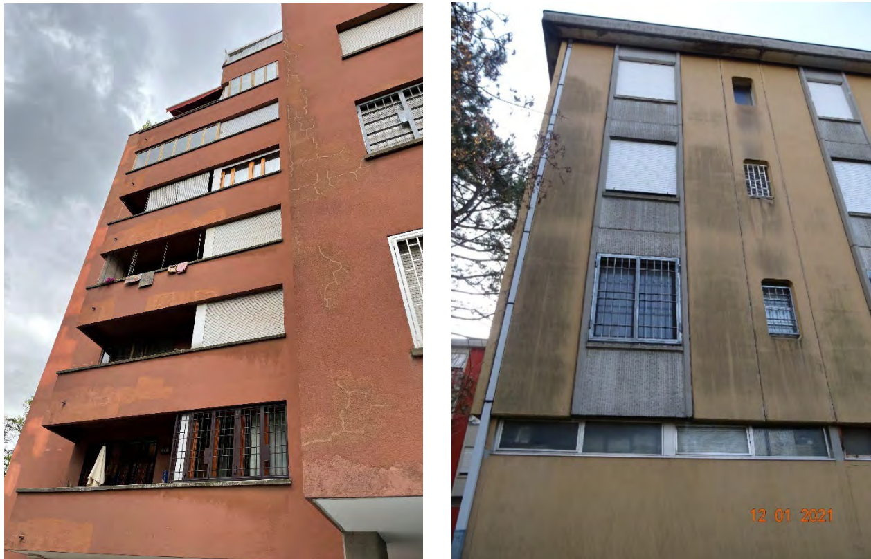
Fig.2 Documentazione fotografica di cantiere. A sinistra, CA_11: nel prospetto sono visibili lesioni e problemi di infiltrazione. A destra, SC_2: nel prospetto sono visibili problemi di infiltrazione e macchie scure.
