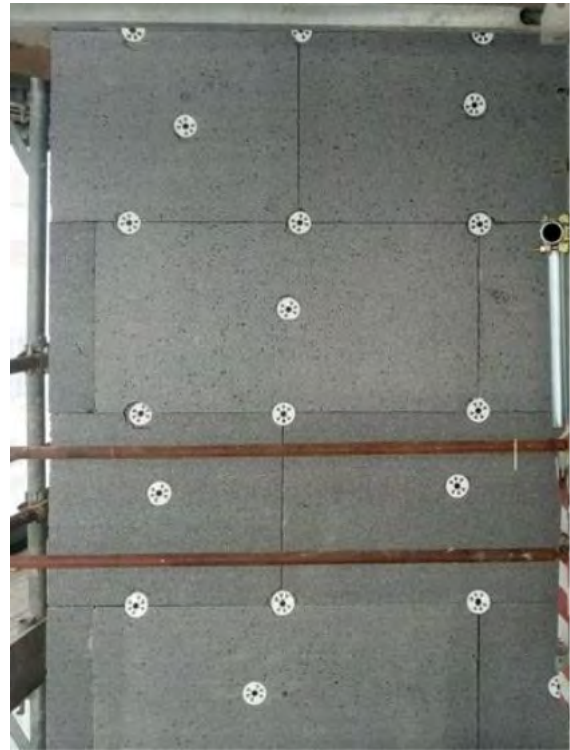
Fig.11 A sinistra, fissaggio meccanico con schema di tasselli a “T” [11]. A destra, M_17: documentazione fotografica di cantiere, fissaggio di pannelli in EPS con grafite.
