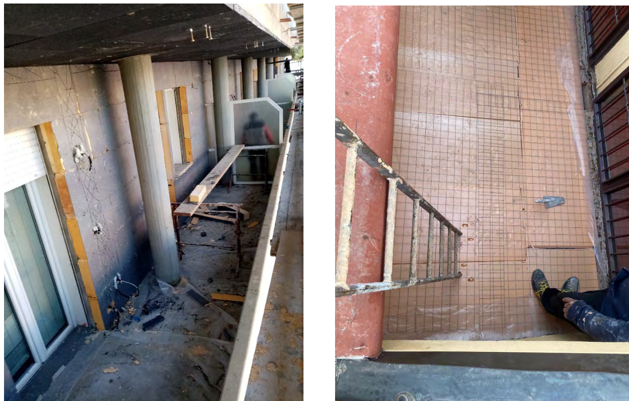
Fig.47 Documentazione fotografica di cantiere. CA_12: Isolamento delle pareti con pannelli in resina fenolica rivestiti in EPS additivato con grafite, dell'intradosso del solaio dei balconi con pannelli in EPS additivato con grafite e XPS per l'estradosso.
