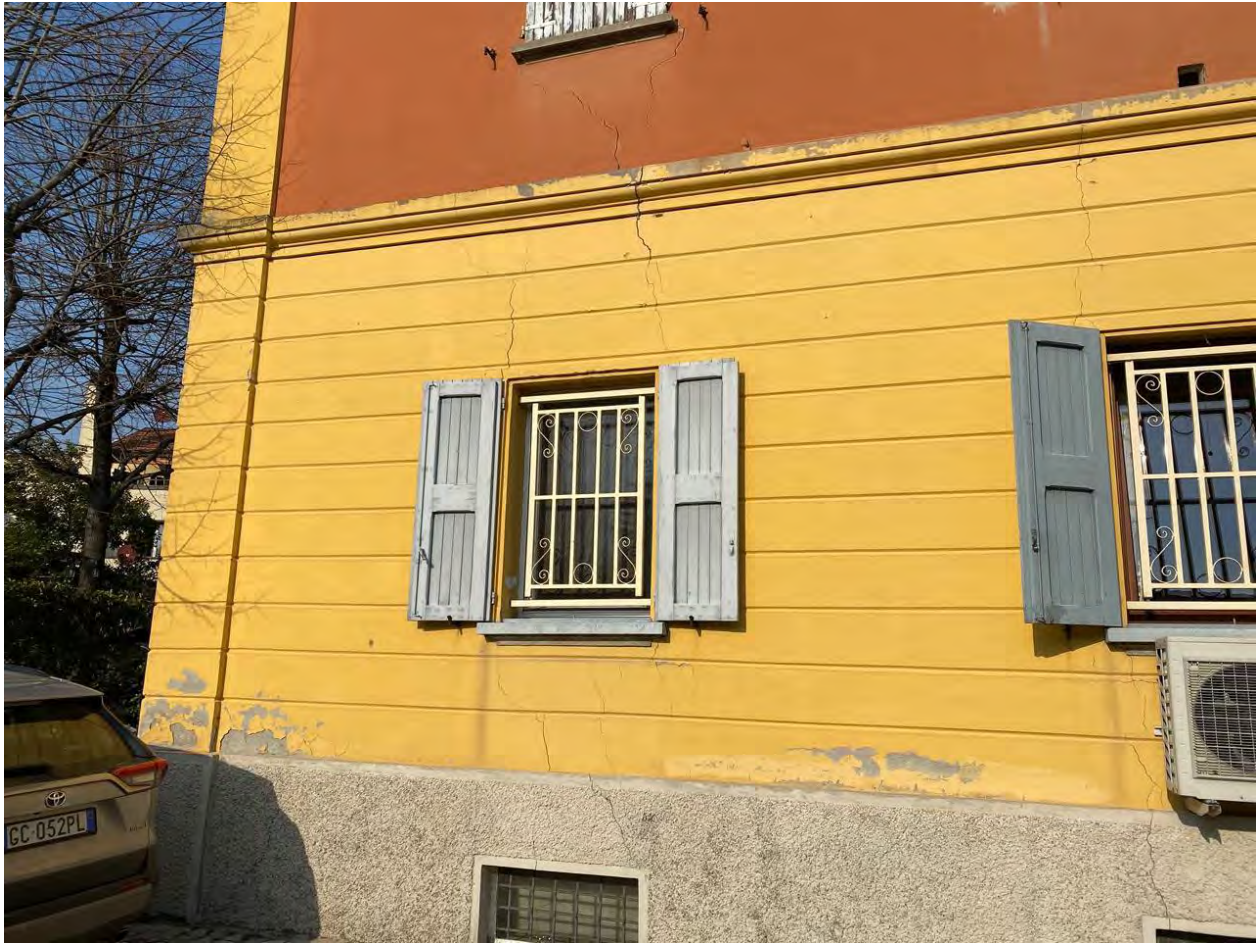
Fig.1 Documentazione fotografica di cantiere. M_28: nel prospetto sono visibili lesioni, problemi di infiltrazione e possibile risalita capillare di umidità.
