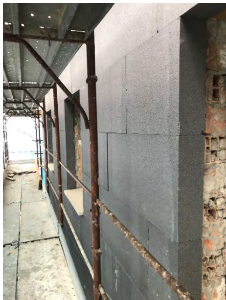
Fig.8 Documentazione fotografica di cantiere, sflasamento dei giunti di almeno 25 cm. Pannelli in EPS additivato con grafite.
