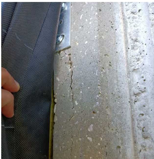
Fig.127 Documentazione fotografica di cantiere. SC: fessurazione del supporto, costituito da pannelli prefabbricati in calcestruzzo armato, dopo l'applicazione degli ancoraggi della parete ventilata.
