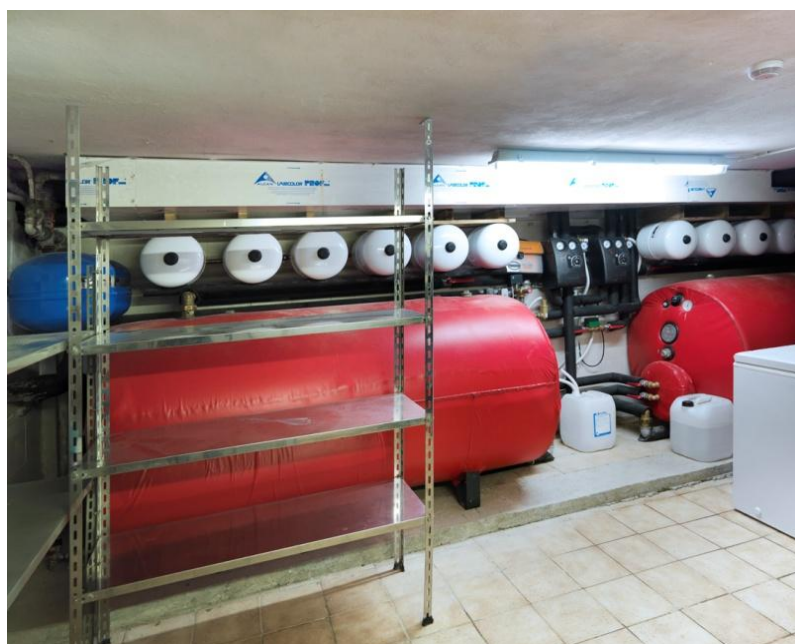
Figura 10 - Hotel Tiffany's (centrale termica)
