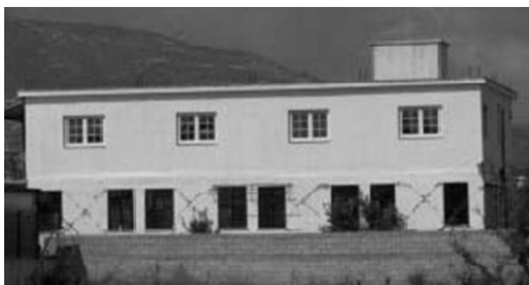
Figura 1.2 - Lesione nel tamponamento
