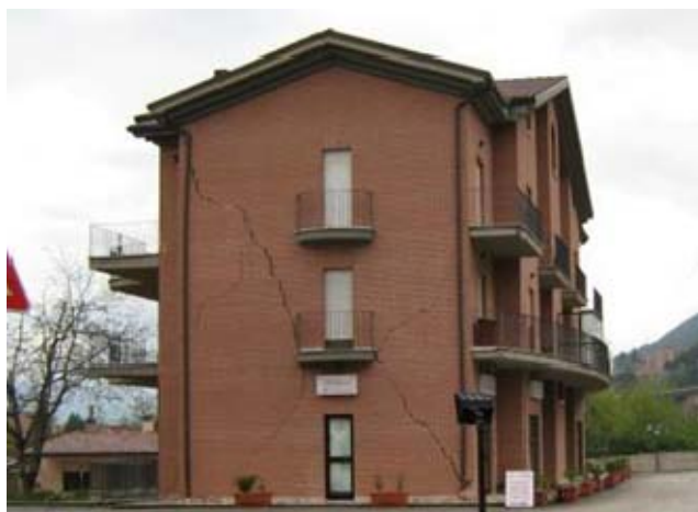
Figura 1.1 - Lesione nel tamponamento
