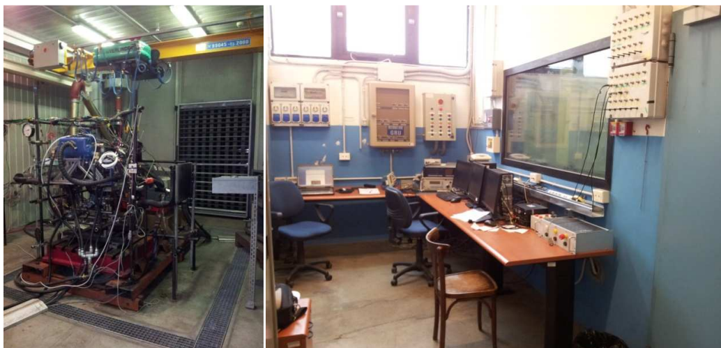
Figura 2.3 Sala Motore e Sala Controllo
