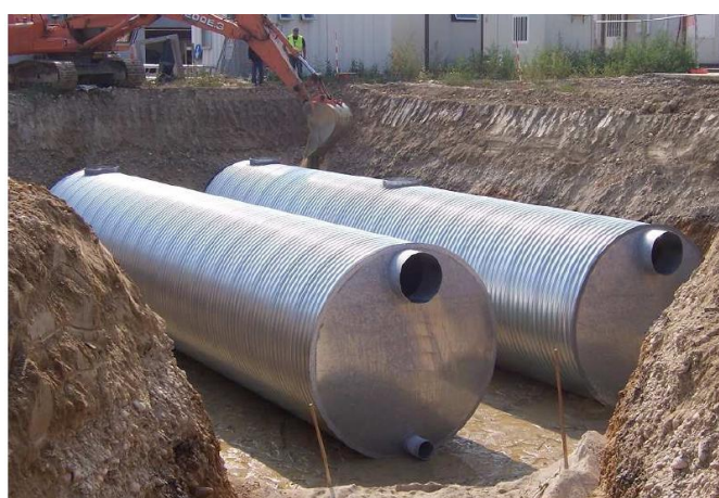
Figura 3.22- Serbatoi in acciaio per lo stoccaggio dell'acqua piovana ( www.euroambiente.info )
